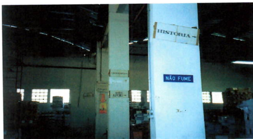
Figura 24 A sinalização é precária e antiga.
