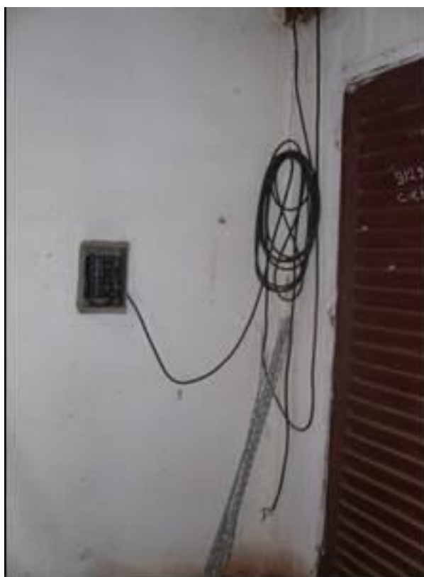
Figura 35 - Quadro elétrico sem tampa, sinalização com fio desencapado, no Prédio do Confinamento, na FEP Horticultura / Zootecnia.
