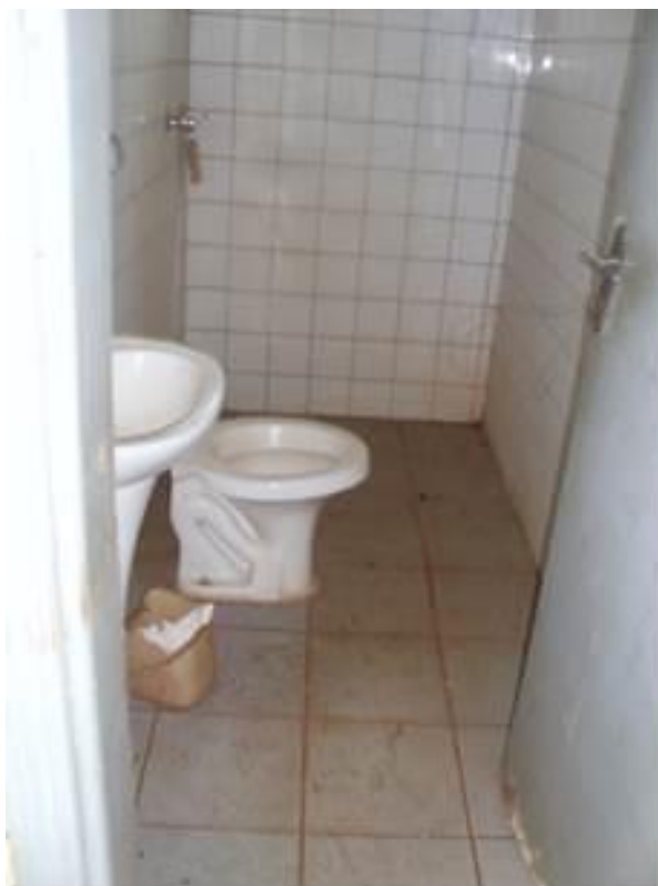
Figura 27 - Banheiro de servidores e usuários com falta de limpeza na FEP Horticultura / Zootecnia. Fonte: Arquivo pessoal.
