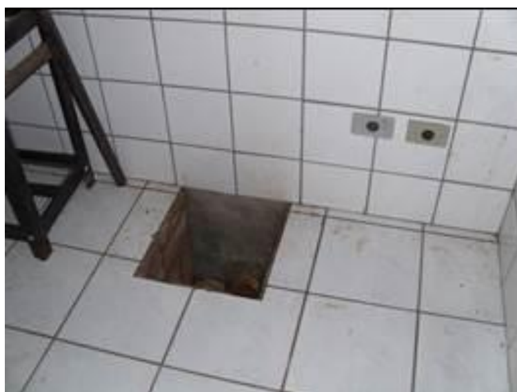
Figura 32 - Caixa de esgoto sem tampa, no Prédio da Avicultura, na FEP Horticultura / Zootecnia.
