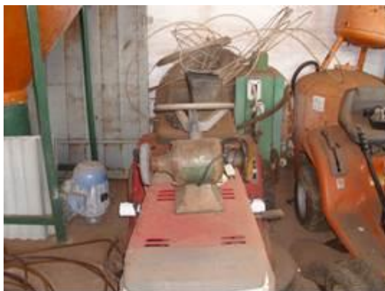
Figura 37 - Esmeril sem proteção no Almoxarifado da FEP Horticultura / Zootecnia.
