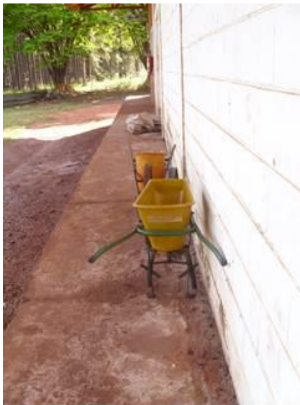
Figura 21 - Área de circulação e de descarga de sacarias sem guarda corpo na FEP Vegetal.
