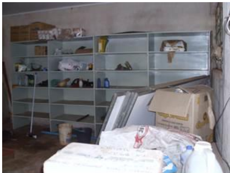
Figura 28 - Armazenamento inadequado: almoxarifado com alimentos e produtos químicos na FEP Horticultura / Zootecnia.
