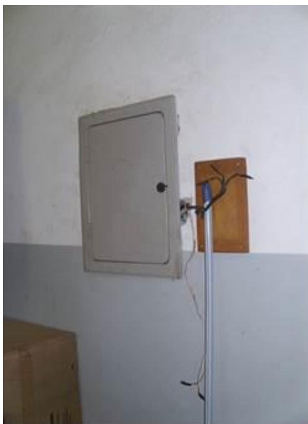
Figura 42 - Quadro elétrico sem sinalização com fios expostos na FEP Parques.
