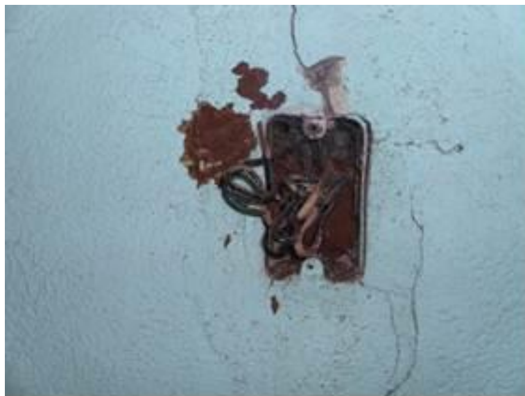
Figura 10 - Tomada desativada com fiação exposta na FEP Vegetal.
