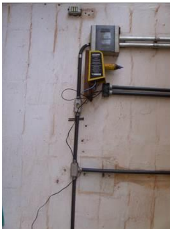
Figura 7 - Cerca elétrica sem sinalização na FEP Animal. Fonte: Arquivo pessoal.
