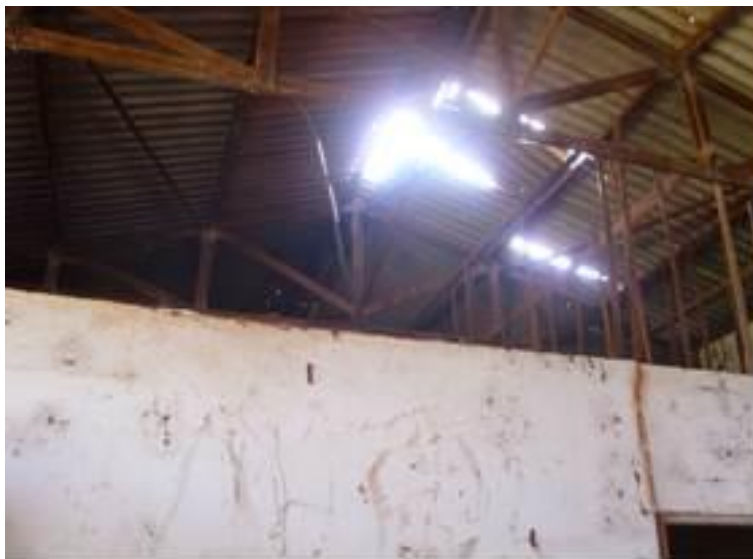
Figura 9 - Depósito de adubo com telhas quebradas na FEP Vegetal.
