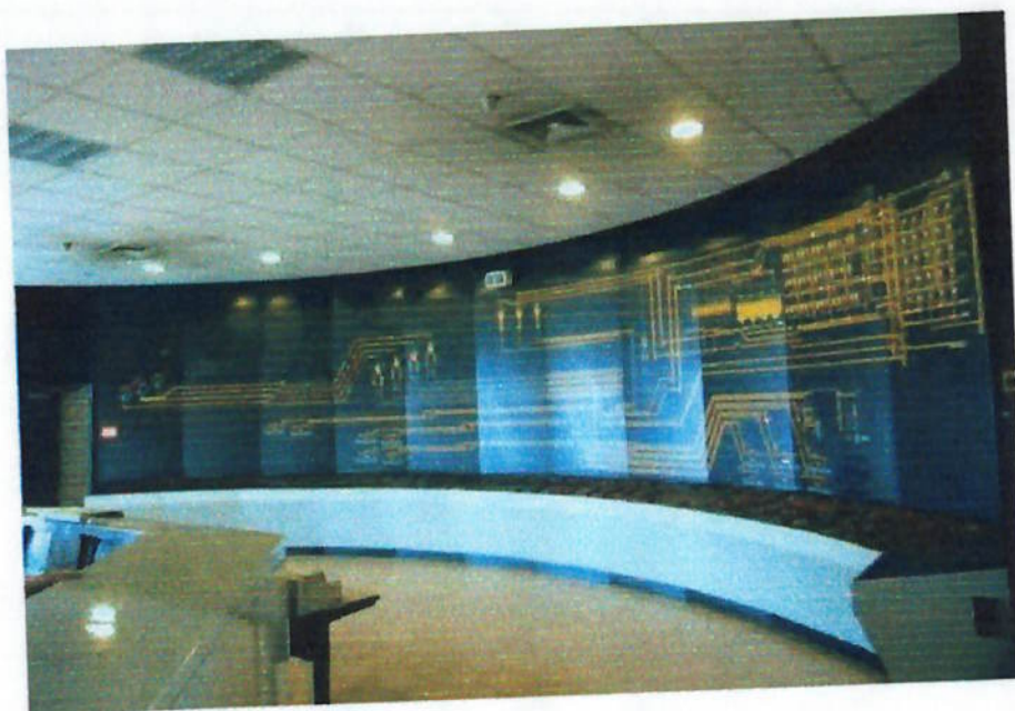
Fig.. 14 – Visão da Sala de Controle do Terminal E.B.S., em Rotterdam
