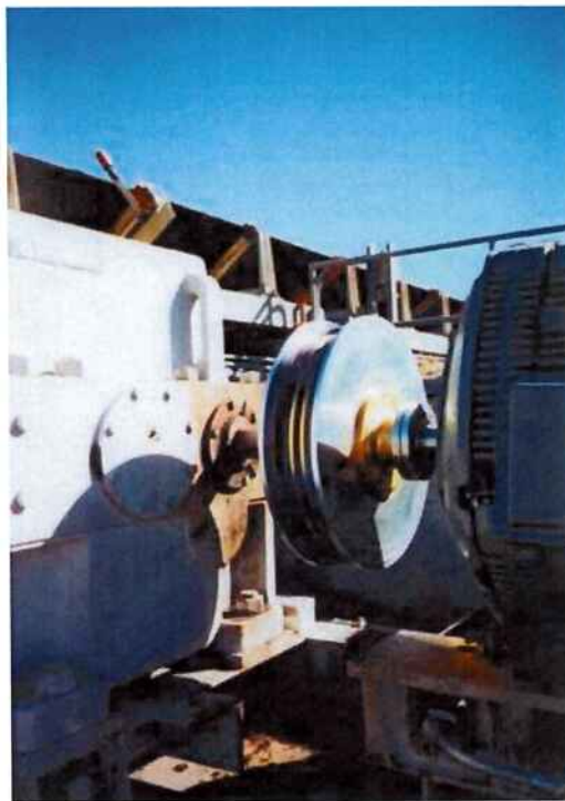
Figura 11 - Exemplo de aplicação do acoplamento magnético: esteira transportadora
