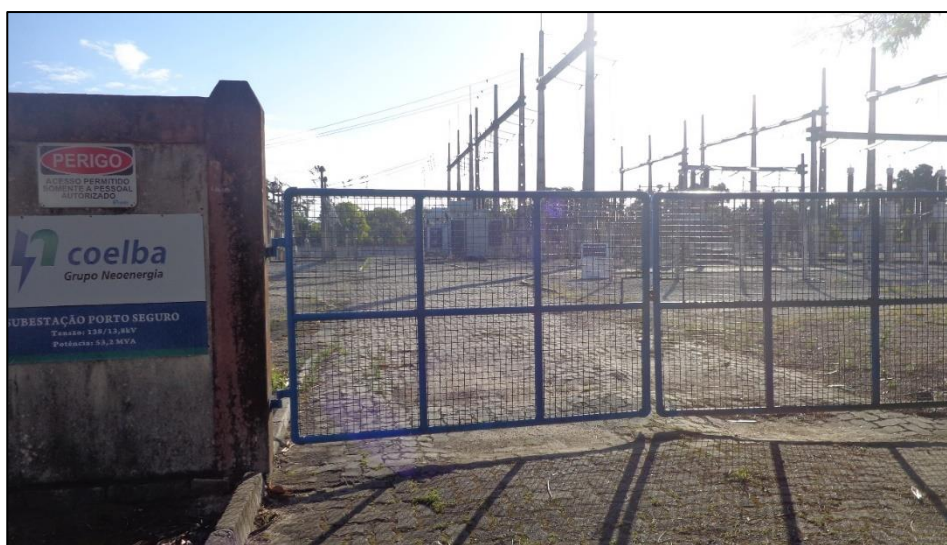
Figura 27: Subestação de distribuição de energia dentro do condomínio Outeiro da Glória. Autora: Juliana Marin dos Santos 24/10/2016
