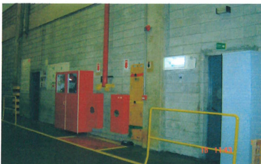
Figura 8 - Detalhe do sistema de combate a incêndio sinalizado.
