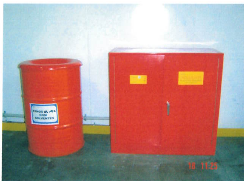
Figura 20 - Lixeira corta-fogo e armário corta-fogo.
