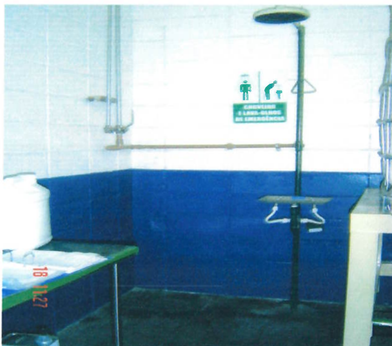
Figura 23 - Área de chuveiros e lava olhos de emergência.
