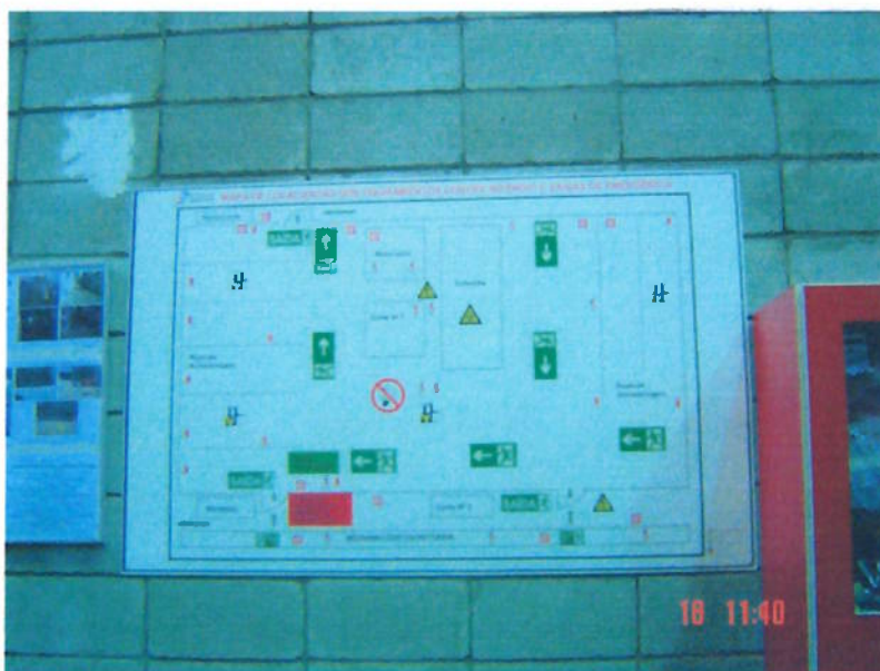
Figura 7- Quadro de identificação do sistema de combate a incêndio.
