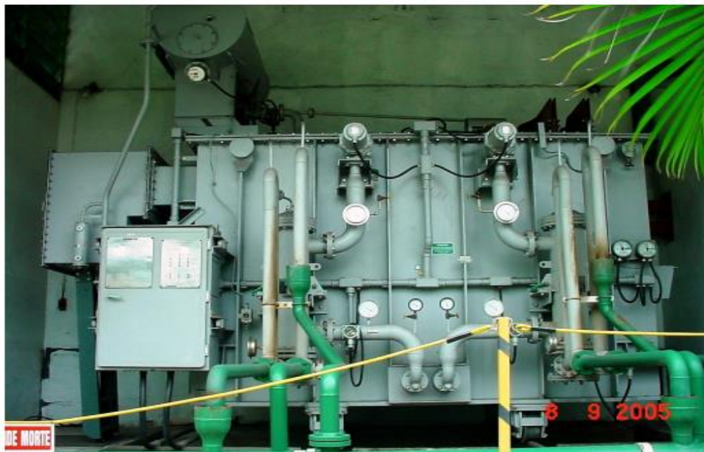
Figura 3.11 Transformador retificador 75kA para eletrólise diafragma – cortesia Unipar Carbocloro.
