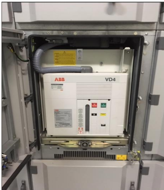
Figura 3.3 Disjuntor de média tensão – cortesia Unipar Carbocloro.
