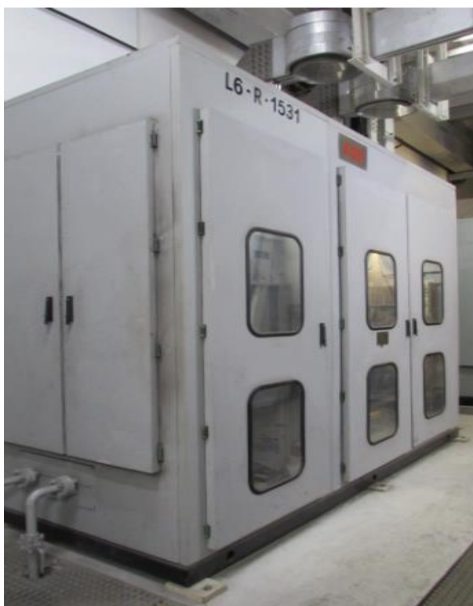
Figura 3.13 Conversor CA/CC tiristorizado 18kA para eletrólise membrana - cortesia Unipar Carbocloro.
