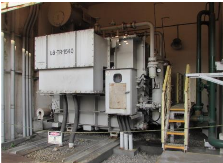
Figura 3.4 Transformador retificador 18kA para eletrólise membrana – cortesia Unipar Carbocloro.
