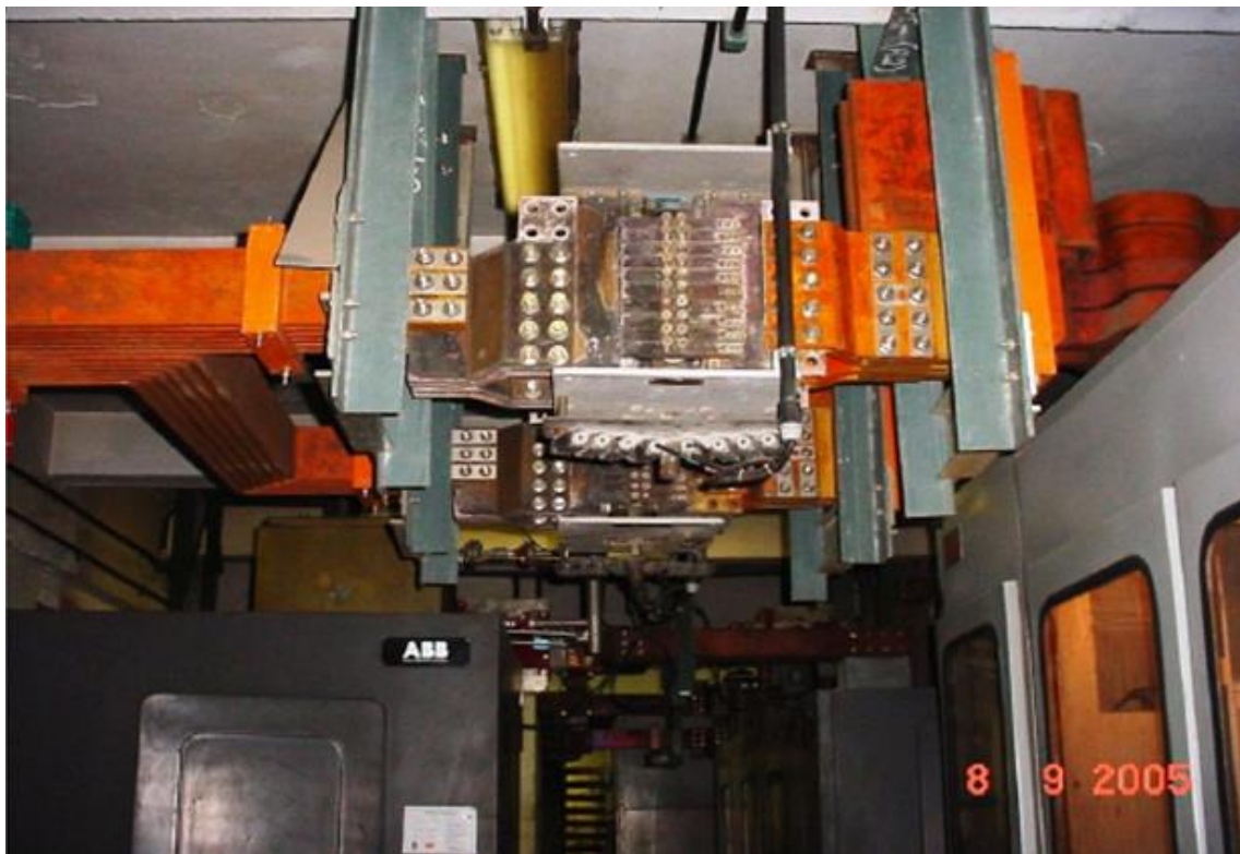
Figura 3.20 Chave seccionadora fabricante Ferraz 40kA – cortesia Unipar Carbocloro.
