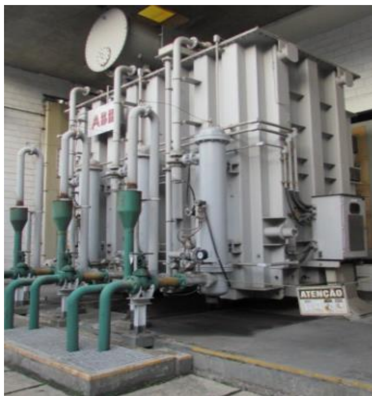
Figura 3.12 Transformador retificador 114kA para eletrólise mercúrio – cortesia Unipar Carbocloro.
