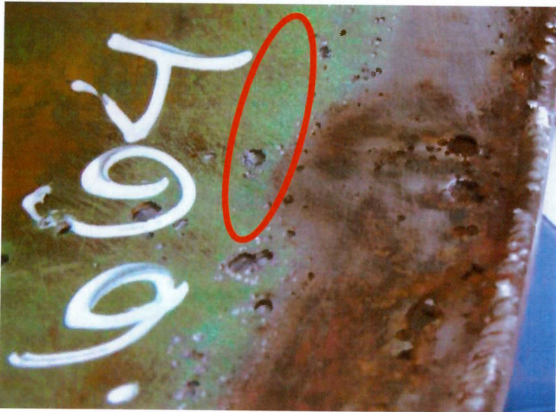
Figura 2.10 – Amostra de pedaço de tubo de aço inoxidável duplex UNS S 31803 retirada de sistema de tubulação em módulo de plataforma de petróleo. A circunferência vermelha mostra a região da zona afetada pelo calor (aproximadamente 2mm distante da região do metal depositado) durante a soldagem do tubo, a qual sofreu corrosão durante trabalho na plataforma, devido a perda da estrutura do aço inoxidável duplex.
