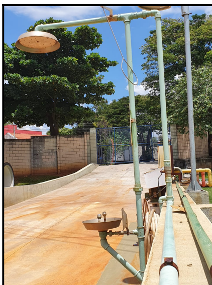
Figura 8 - Baia de Descarregamento de Produtos Químicos – Vista Interna
