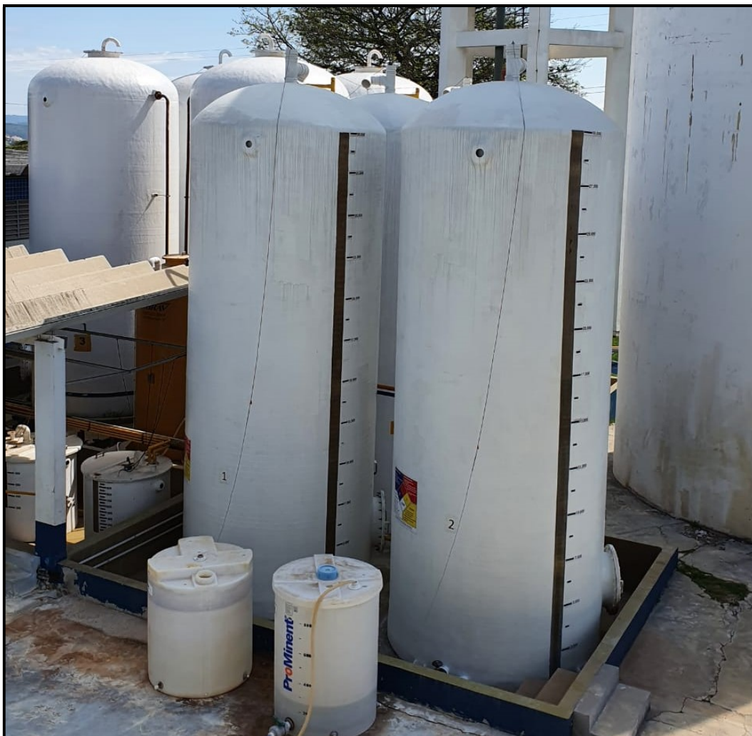
Figura 13 - Silos de Armazenamento
