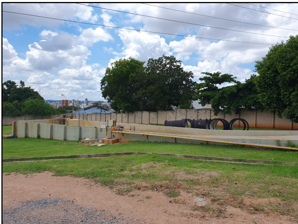
Figura 9 - Baía de Descarregamento de Produtos Químicos – Vista Lateral
