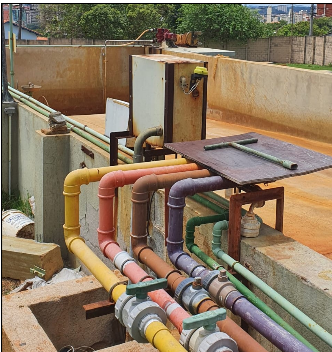
Figura 12 - Tubulações da Baía de Descarregamento
