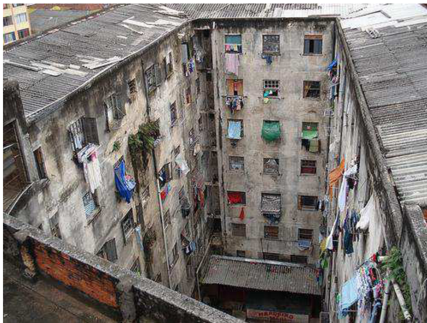
Figura 22: pátio interno visto da cobertura. A foto foi tirada do reservatório de água superior, localizado sobre a laje. Note-se que há telhas na outra porção. Foto tirada pelo grupo.
