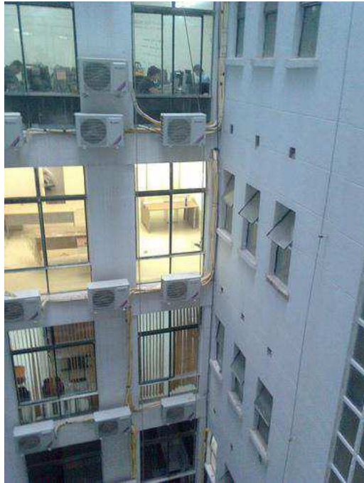
Figura 58: sistema de ar condicionado visto pelo pátio interno. Foto tirada pelo grupo.
