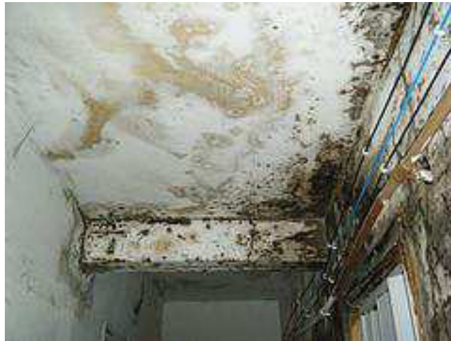
Figura 47: degradação por umidade nas vigas e lajes do corredor. Foto tirada pelo grupo.
