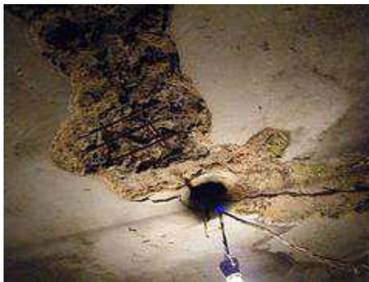
Figura 46: corrosão em laje sobre a lavanderia. Foto tirada pelo grupo.
