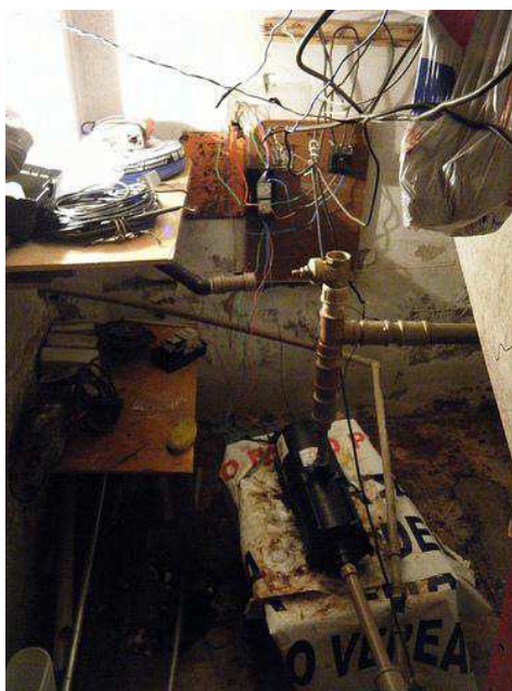
Figura 29: bomba d'água e tubulações de sucção e recalque. Foto tirada pelo grupo.
