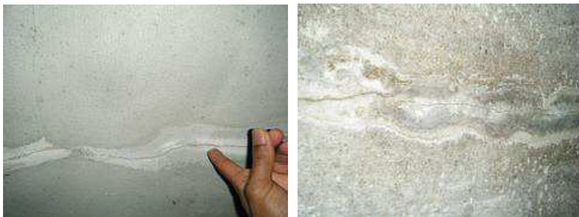
Figura 50: formação de goteiras na laje do ático. Fotos tiradas pelo grupo.
