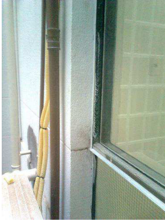
Figura 56: detalhe do sistema hidráulico no edifício da Xavier Toledo – tubulações no pátio interno. Foto tirada pelo grupo.
