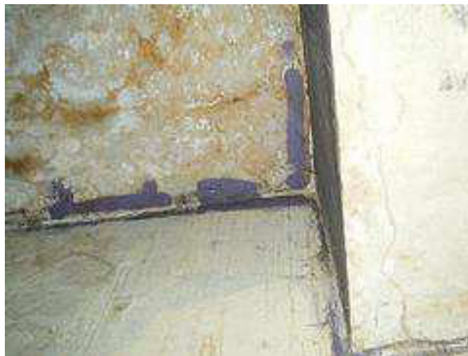
Figura 48: formação de goteiras laje da cobertura. Foto tirada pelo grupo.
