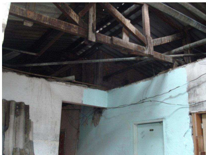
Figura 41: teto do último andar. Foto tirada pelo grupo.
