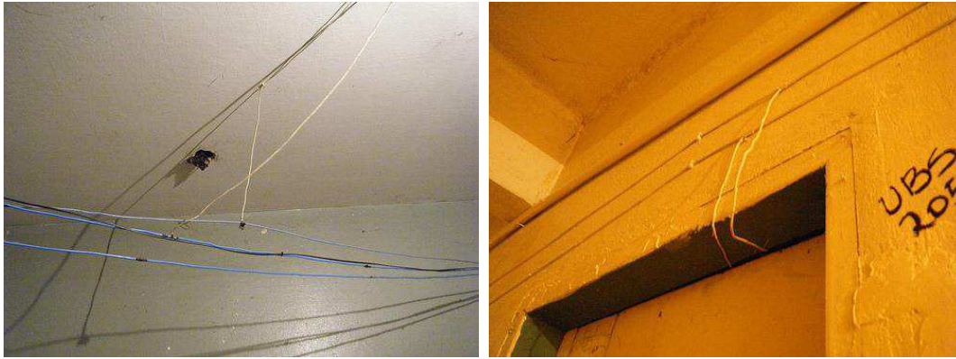
Figura 36: fiação exposta nos corredores e detalhe da conexão com cada apartamento. Fotos tiradas pelo grupo.
