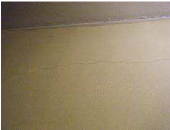
Figura 49: fissura na parede do cômodo (vista do corredor). Foto tirada pelo grupo.
