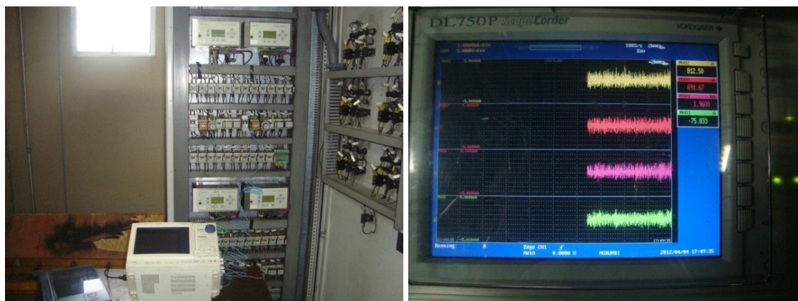
Figura 15 – Instalação dos Yokogawa modelo DL750P nas subestações
