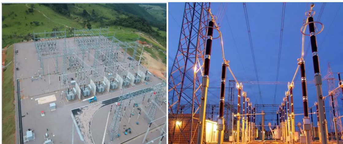
Figura 3 – Fotos de Subestações e alguns equipamentos.
