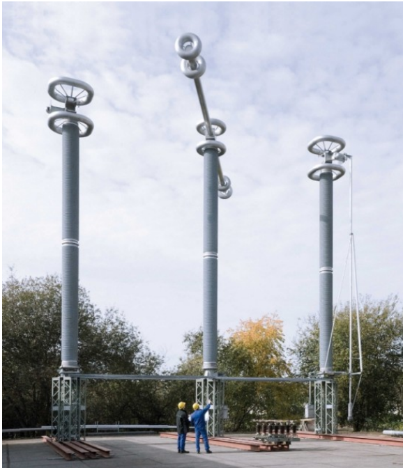
Figura 12: Chave seccionadora de abertura horizontal da SIEMENS. Fonte: (SIEMENS, 2020b).
