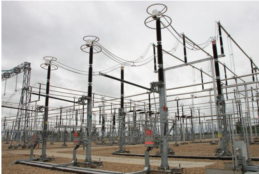
Figura 15: Imagem de subestação com barramento trifásico rígido. Fonte: ( ALLBIZ, 2020 ).
