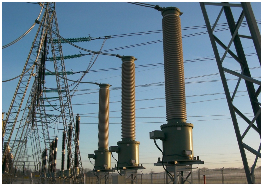
Figura 10: Transformadores de potencial isolados por SF 6 . Fonte: ( TRENCH Group, 2020 ).
