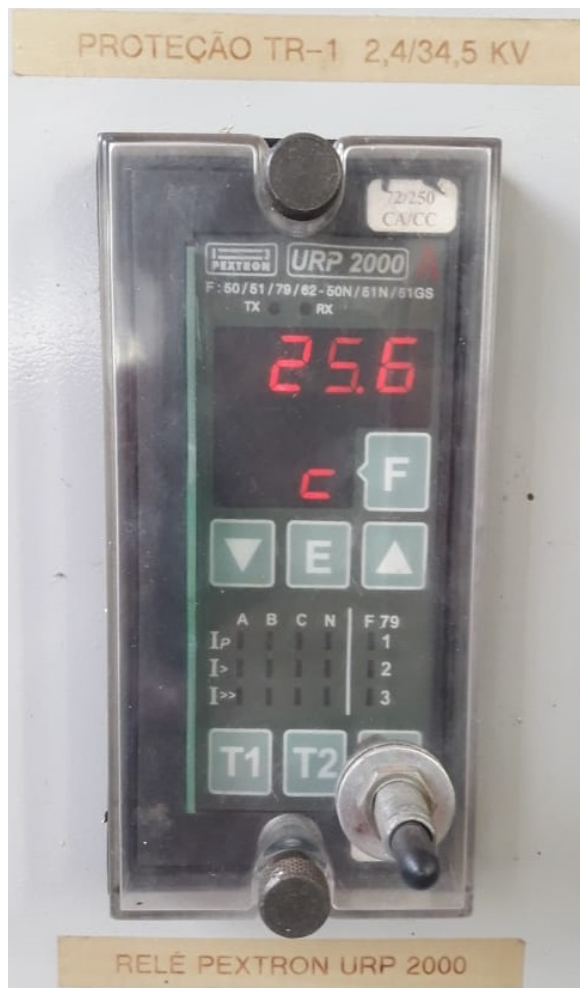
Figura 27: Relé URP-2000 instalado para a proteção do transformador. Fonte: Usina Lobo (2020)
