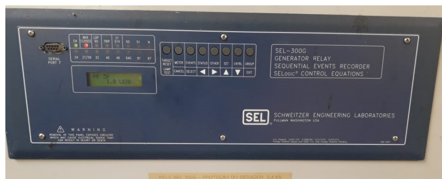
Figura 25: Relé SEL-300G instalado para a proteção do gerador. Fonte: Usina Lobo (2020)
