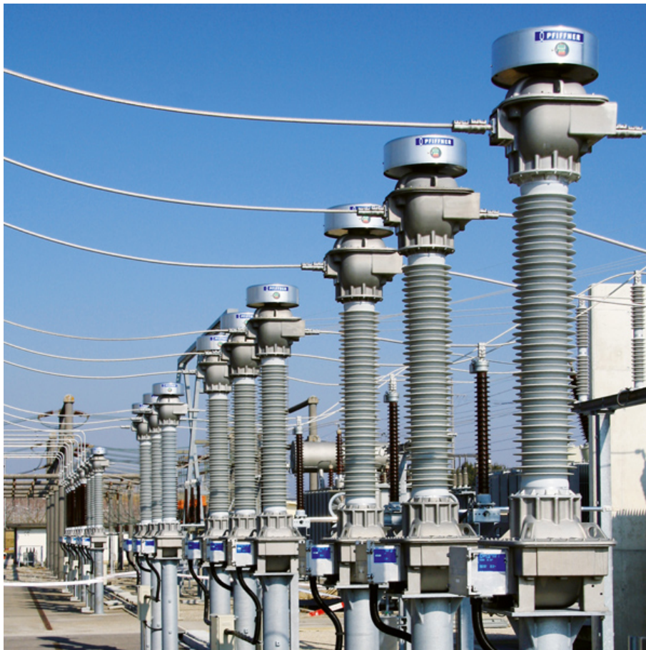
Figura 9: Transformadores de corrente isolados por SF 6 . Fonte: (PFIFFNER, 2020).
