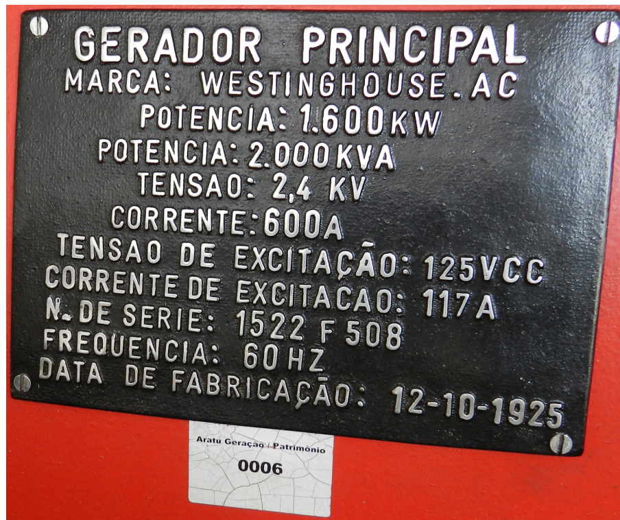
Figura 23: Placa de dados técnicos do gerador utilizado na PCH. Fonte: Usina Lobo (2020)
