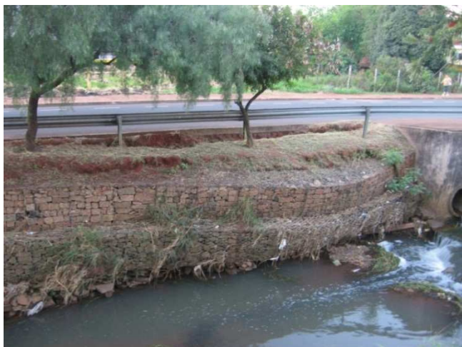
Foto 7: Córrego do Gregório, margem de construção antiga sofrendo desabamento devido à erosão.
