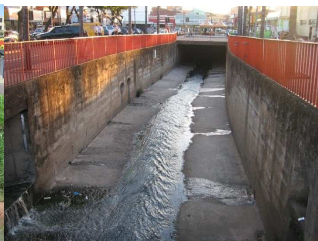
Foto 6: Córrego do Gregório em frente ao Mercado Municipal, com grande ocorrência de enchentes.
