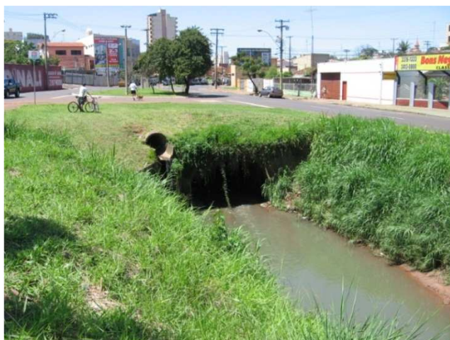
Foto 5: Final do trecho canalizado do córrego Gregório, onde se pode sentir cheiro forte de esgoto.
