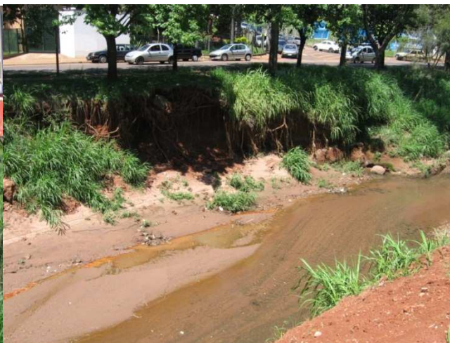
Foto 4: Assoreamento no Córrego do Gregório.
