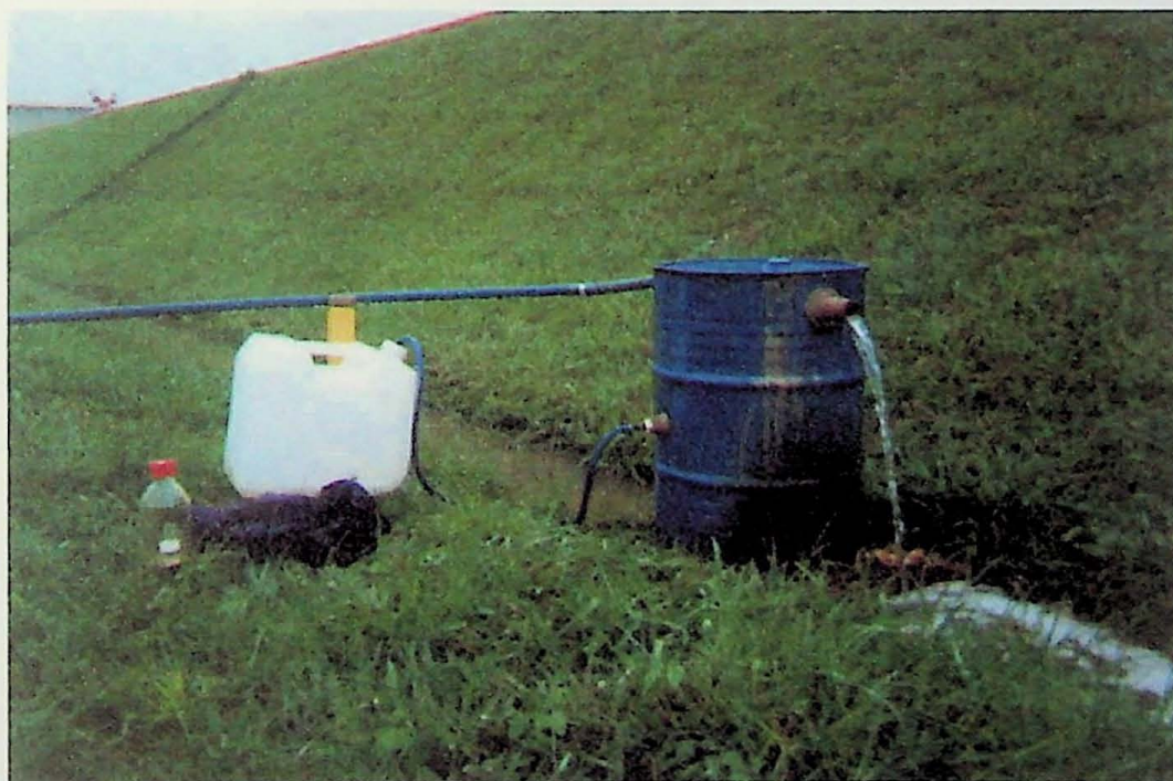
Figura 07: Caixa Separadora Água/Óleo com água separada sendo jogada na canaleta.
