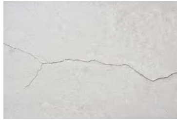
Figura 5 – Amostra de fissura
