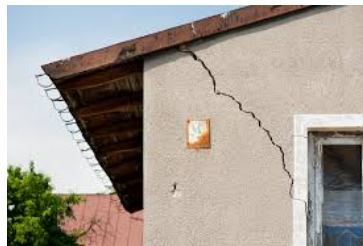
Figura 6 – Amostra de rachadura
