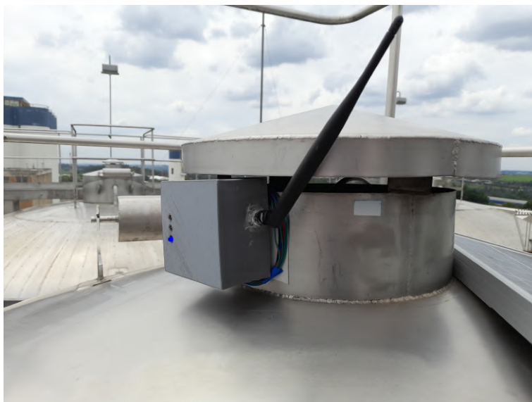
Figura 37 – Protótipo final instalado em reservatório de gás carbônico
