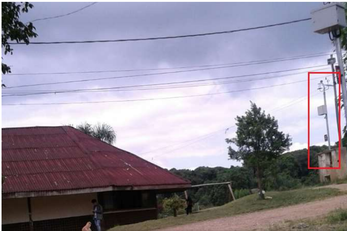
Figura 43 - Estação Parelheiros-Barragem/CGE, Estrada João Lang, 153 – Barragem (Aldeia Guarani Tenodé-Porã), -23.8677777778 -46.6522222222. Foto por: Rodolfo Alves, 2017.
