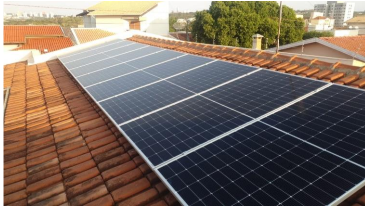
Figura 13 - Instalação do sistema fotovoltaico para cliente exercida através do modelo tradicional de compra e revenda pela empresa do próprio discente.
