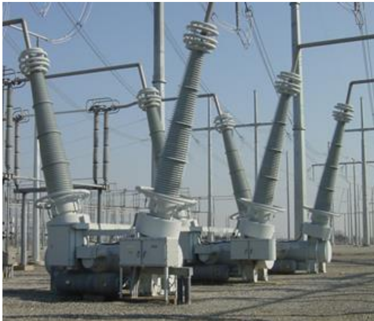
Figura 4 - Disjuntor externo em destaque.
