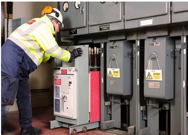
Figura 3 - Disjuntor interno em destaque com um funcionário.
