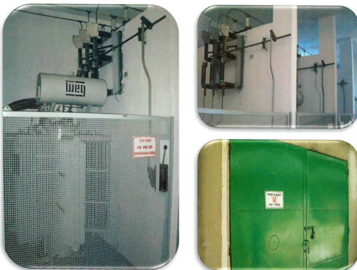
Figura 26: Cabine Primária (Entrada de Força).
