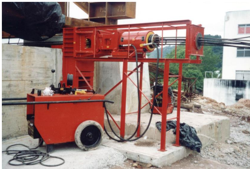
Figura 50: Macaco Hidráulico do Equipamento de Lançamento – Fonte: [WAIMBERG, 2002]
