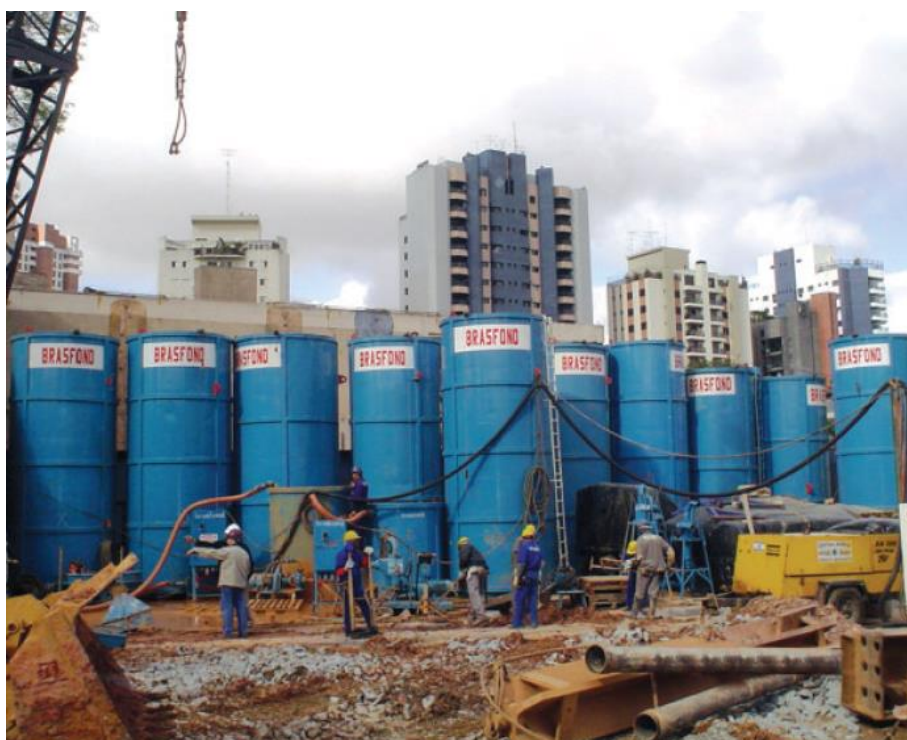
Figura 134: Central de Lama Bentonítica
