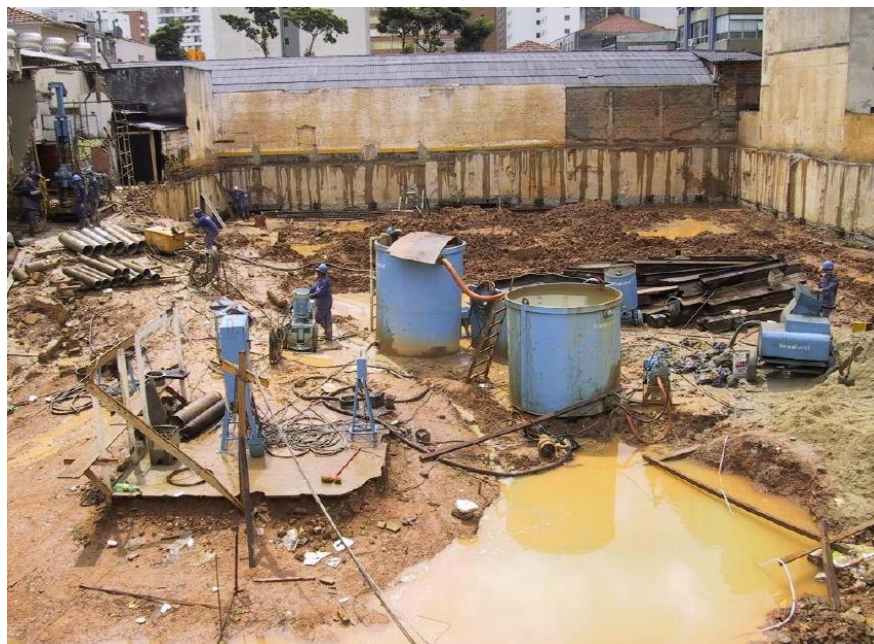
Figura 133: Central de Lama Bentonítica
