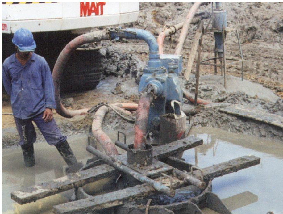
Figura 138: Desarenador em Operação
