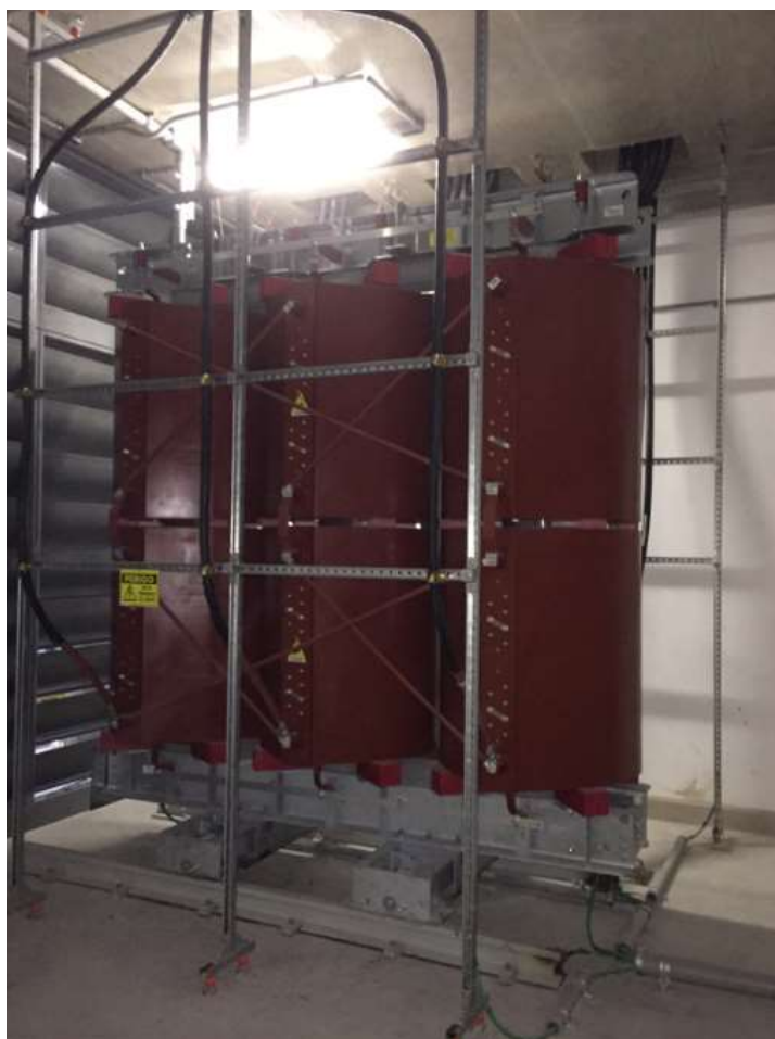
Figura 3.6 - Transformador retificador instalado na estação Brooklin
