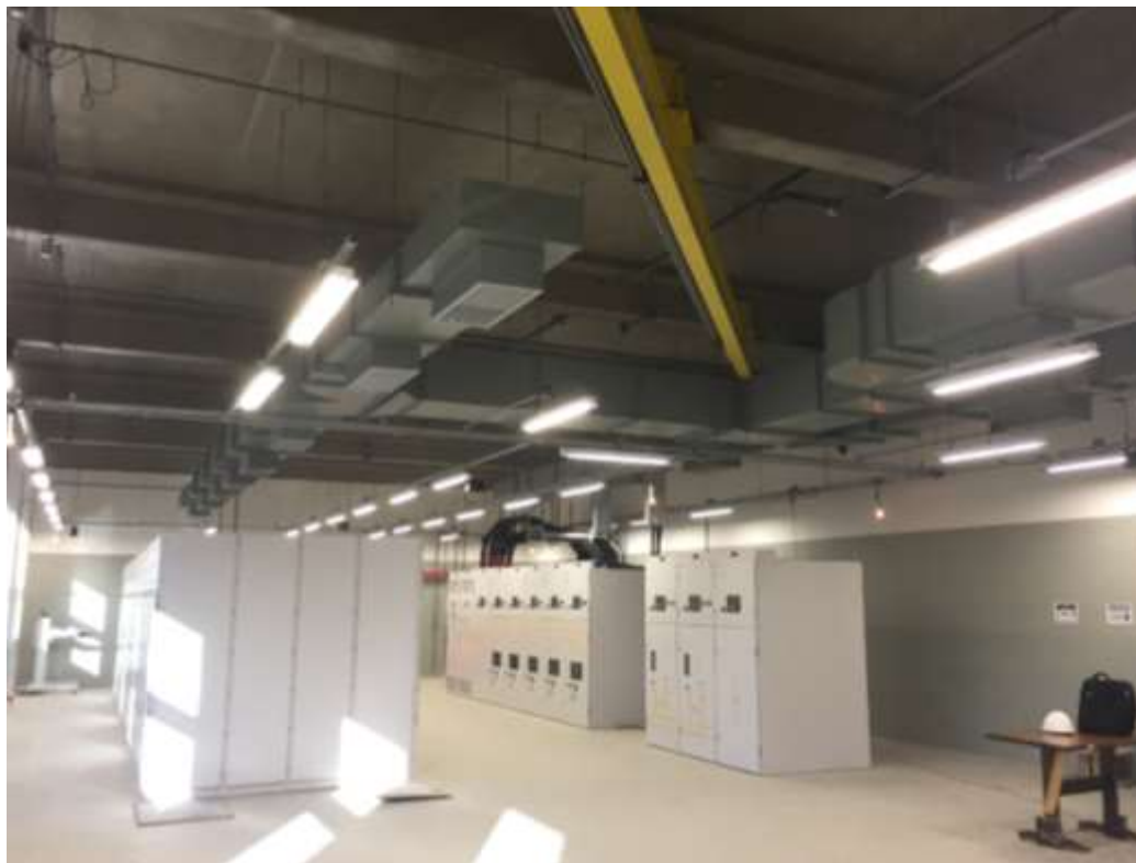
Figura 4.1 - Cubículos de tração e média tensão instalados logo abaixo da laje onde serão instalados os painéis fotovoltaicos
