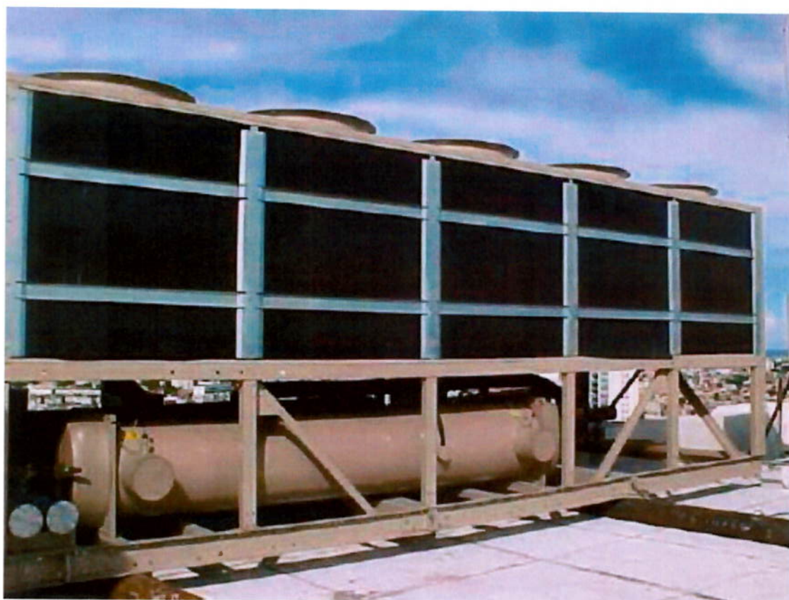
Figura 4.11 – Chiller com condensação a ar
