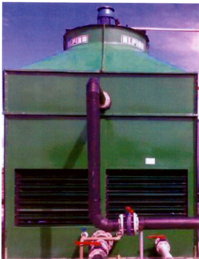
Figura 4.14 – Torre de resfriamento
