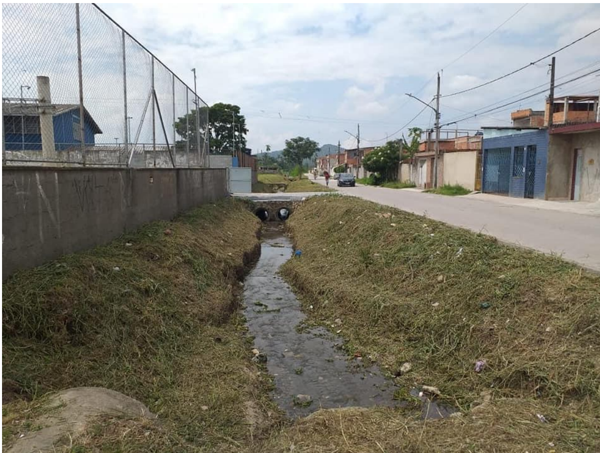
Imagem 11: Córrego aberto em área urbana - Vargem Grande.
