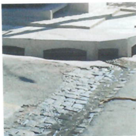
Foto 11-5 – Boca de lobo colocada em pontos baixos.
