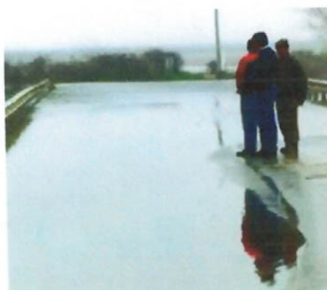
Foto 11-3 – Sarjetas fora das diretrizes
