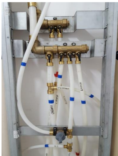
Figura 17 – Conjunto de manifolds no banheiro de serviço
