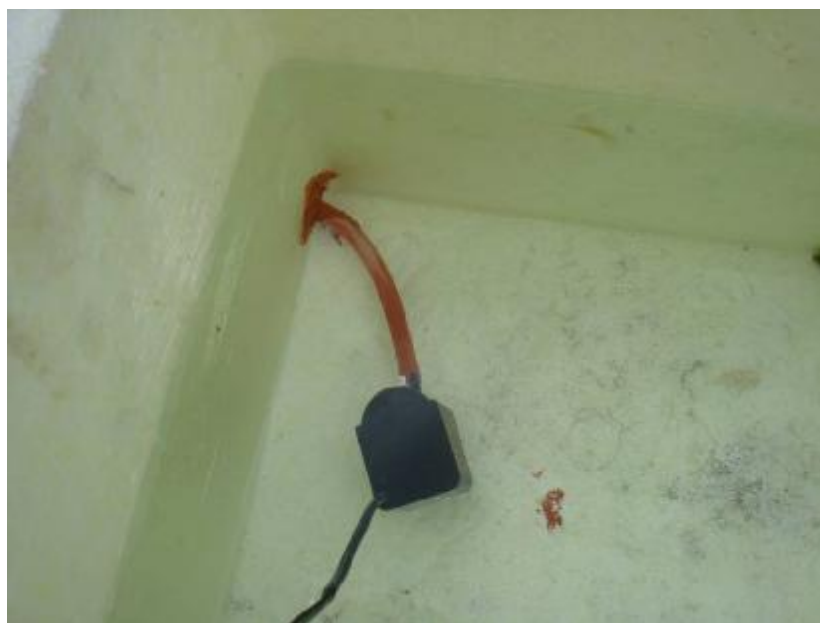
Foto 9 - Posicionamento da bomba no interior do reservatório
