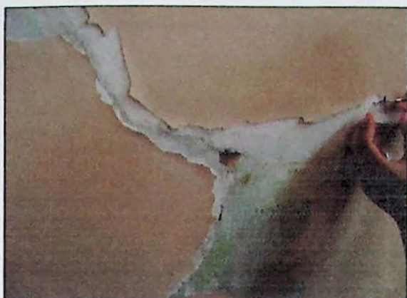
Figura 6.08. Aspecto da parede com massa de regularização da superfície pintada aparente - amostra HC-01. Notar coloração esverdeada da pintura anterior sob camada de tinta atual (Capela do Hospital das Clínicas).
