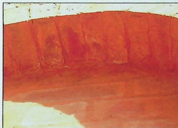
Figura 6.03. Detalhe da eflorescência na parte superior do arco do muro.
