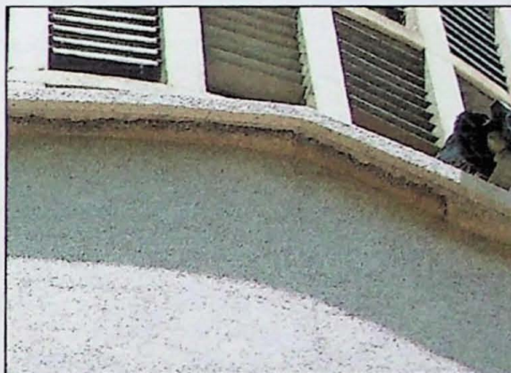
Figura 6.10. Detalhe de região abrigada da luz solar com coloração escura do revestimento. Edifício Itália.
