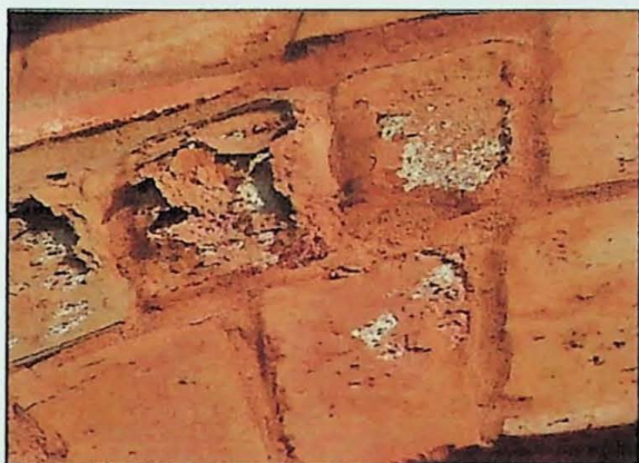
Figura 6.02. Detalhe da eflorescência no muro ao redor da Estação da Luz
