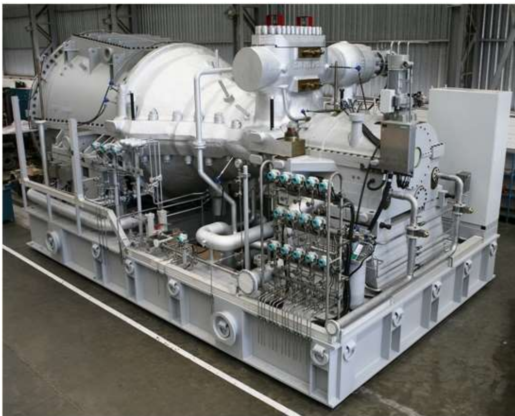
Figura 15 – Turbina a vapor.
