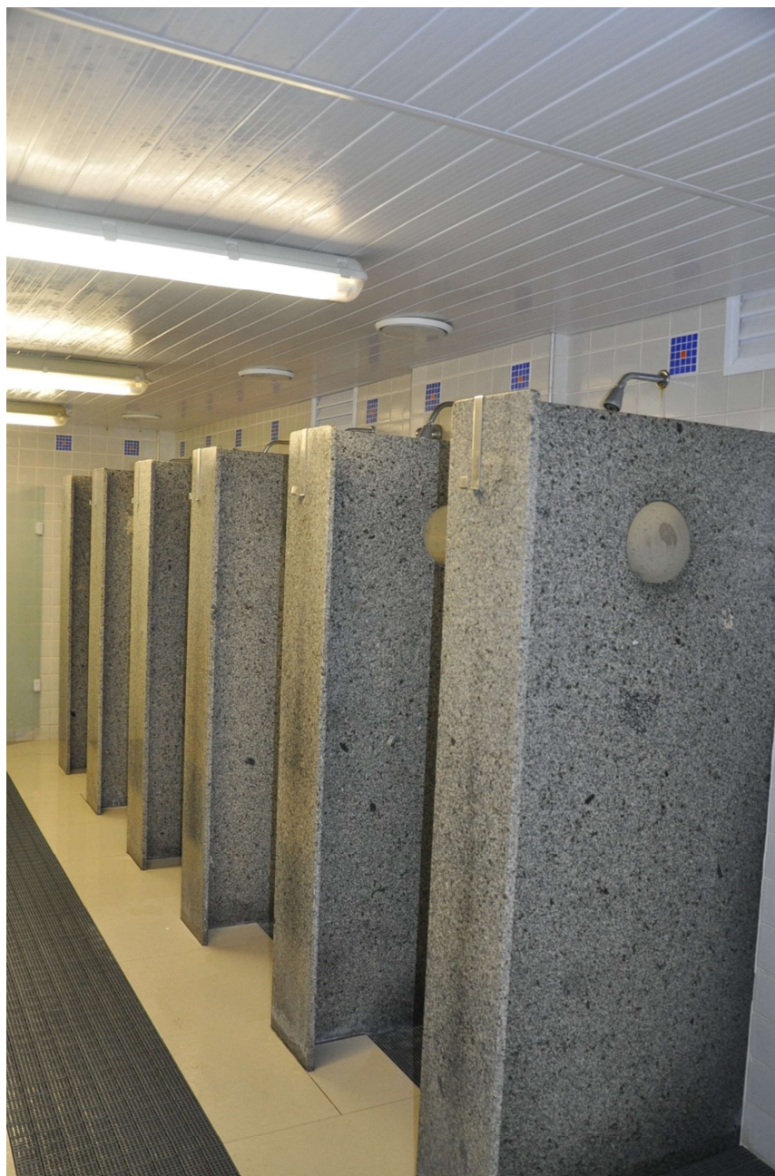
Figura 36 - Chuveiros vestiário masculino.
