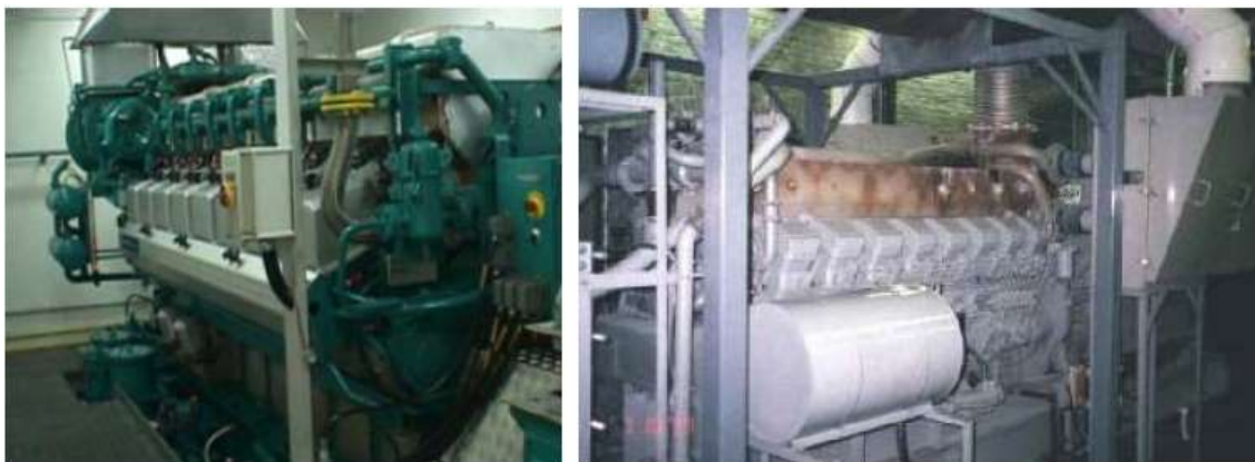
Figura 17 – Motores de combustão interna a gás natural.
