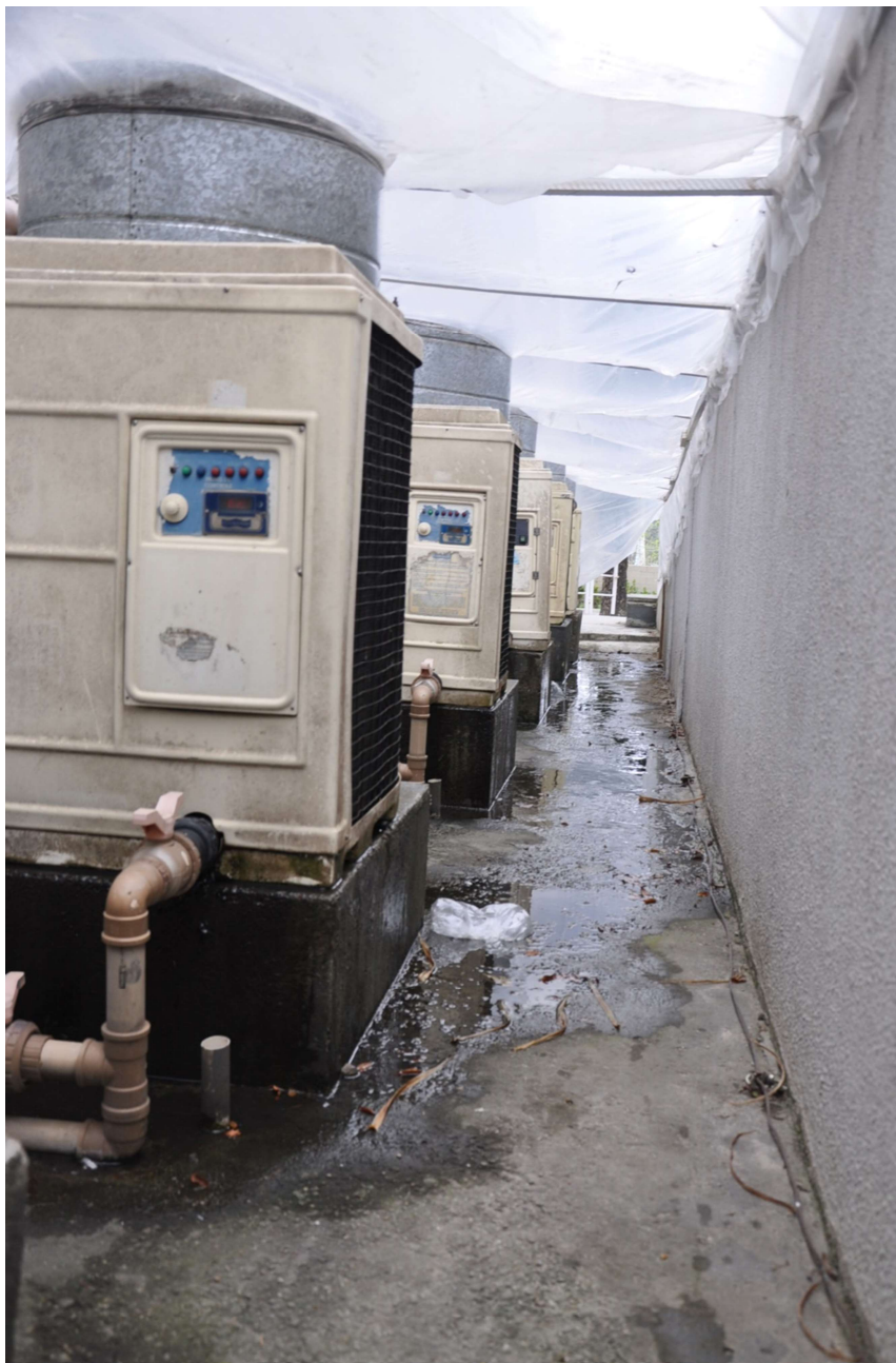
Figura 44 - Bombas de calor elétricas.
