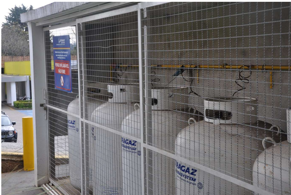
Figura 48 - Tanques de armazenamento de GLP.
