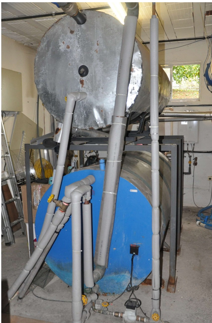
Figura 49 - Tanques de armazenamento de água quente para chuveiros.
