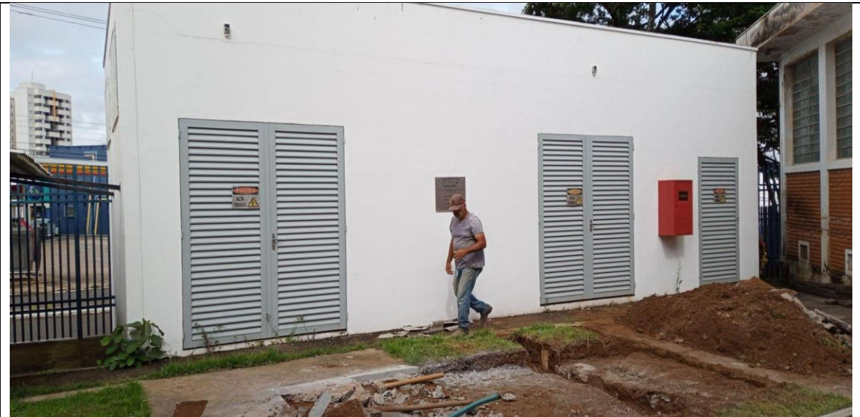
Figura 6: Vista da unidade consumidora IFSC I
