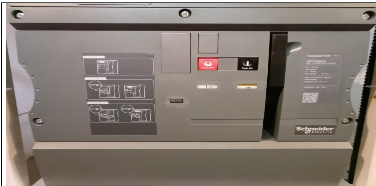
Figura 8: Disjuntor principal da unidade consumidora IFSC II
