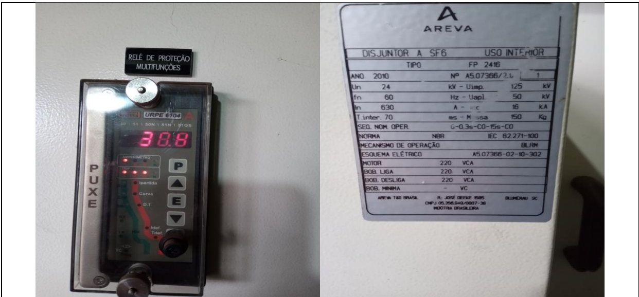
Figura 5: Relé de proteção e Disjuntor principal da unidade consumidora Área Sul
