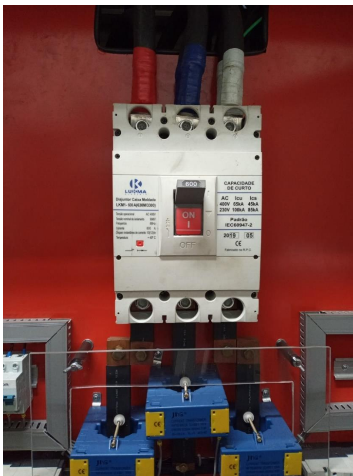
Figura 16: Disjuntor do Quadro de Distribuição Principal CA
