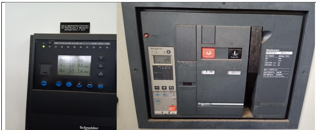
Figura 8: Relé de proteção e Disjuntor principal da unidade consumidora IFSC I
