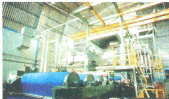
Figura 2 - Vista parcial da calandra
