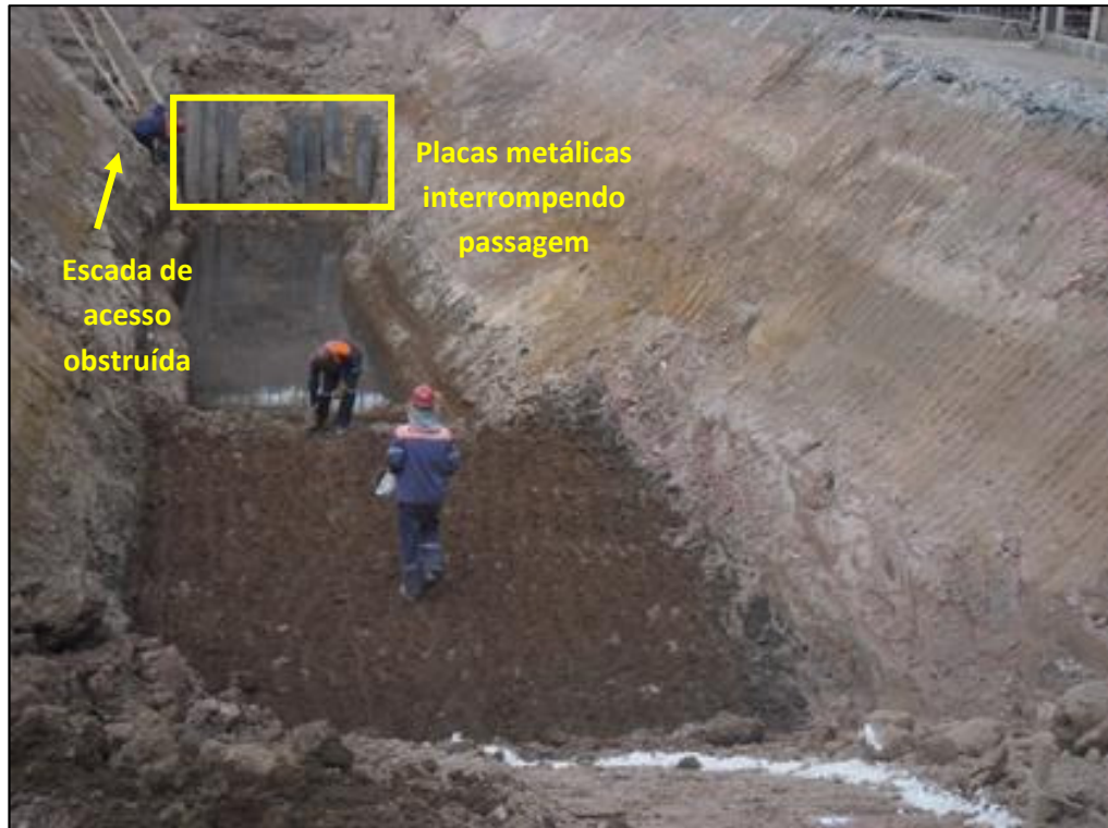
Figura 63: escada com acesso obstruído. Fonte: Arquivo pessoal, 2012.
