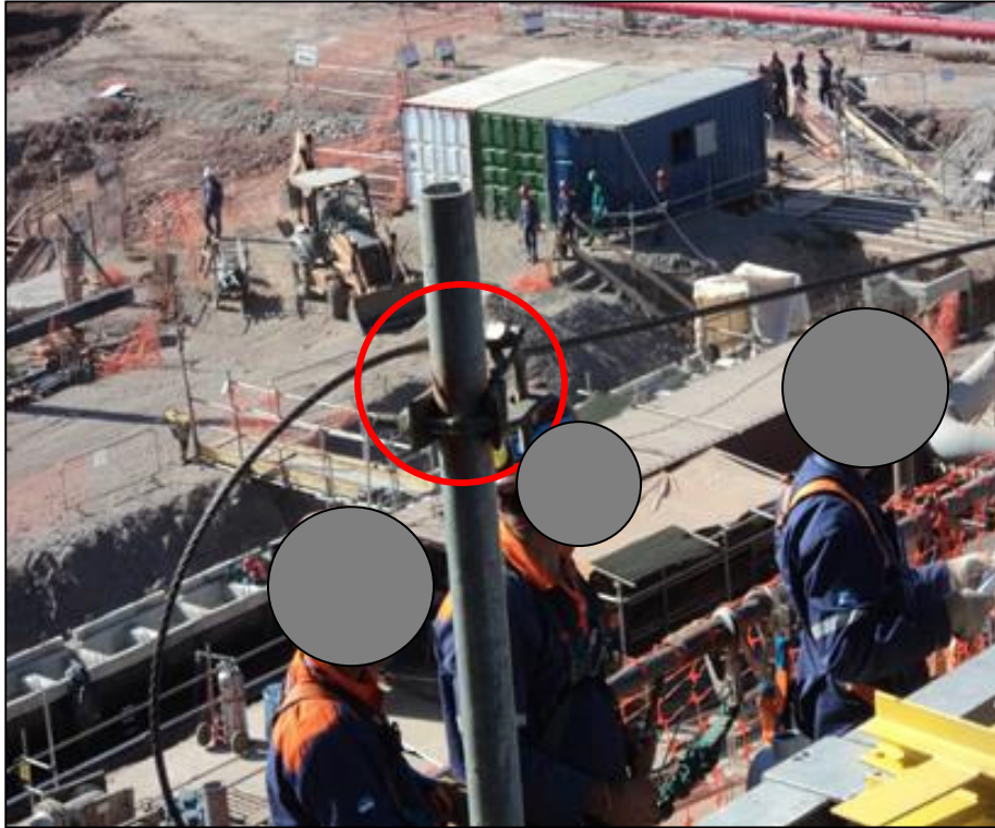
Figura 58: ponto de ancoragem. Fonte: Arquivo pessoal, 2012.
