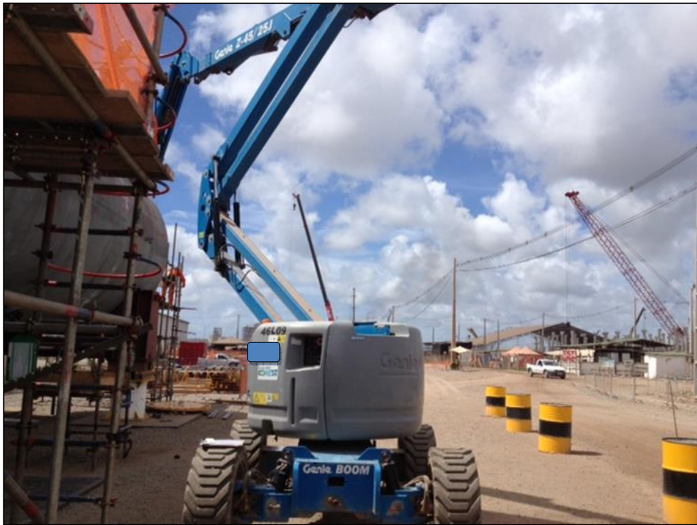
Figura 46: plataforma aérea tipo articulada próximo à via de acesso. Fonte: Arquivo pessoal, 2012.
