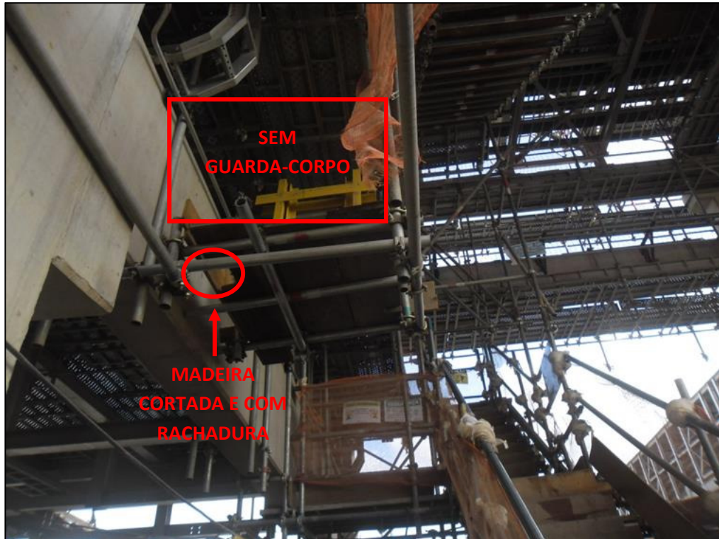
Figura 48: plataforma com piso inadequado. Fonte: Arquivo pessoal, 2012.
