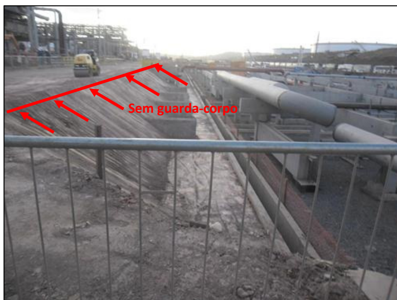
Figura 56: talude sem proteção. Fonte: Arquivo pessoal, 2012.
