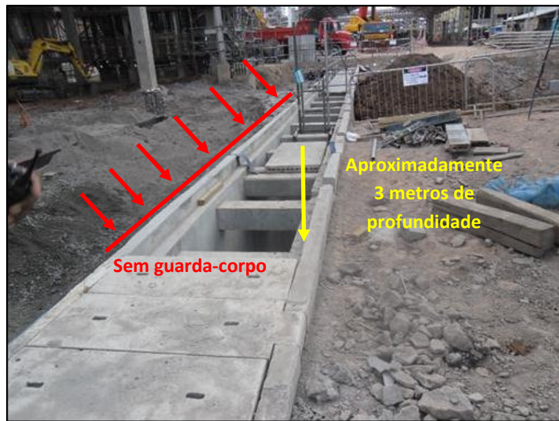
Figura 55: canaleta sem proteção. Fonte: Arquivo pessoal, 2012.
