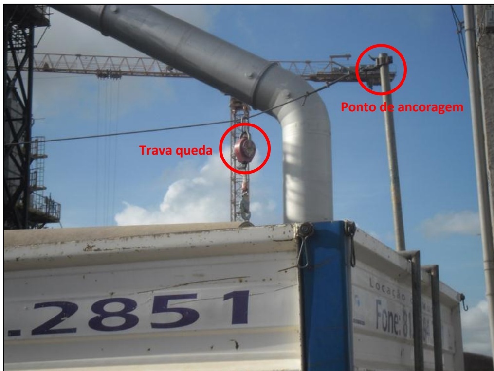
Figura 60: trava queda e ponto de ancoragem. Fonte: Arquivo pessoal, 2012.
