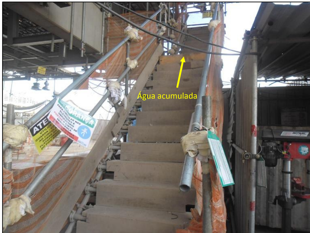
Figura 64: patamar intermediário com água acumulada. Fonte: Arquivo pessoal, 2012.
