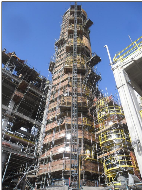
Figura 70: elevador utilizado na obra. Fonte: Arquivo pessoal, 2012.
