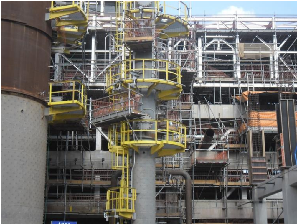
Figura 54: guarda-corpo fixo e guarda-corpo provisório. Fonte: Arquivo pessoal, 2012.
