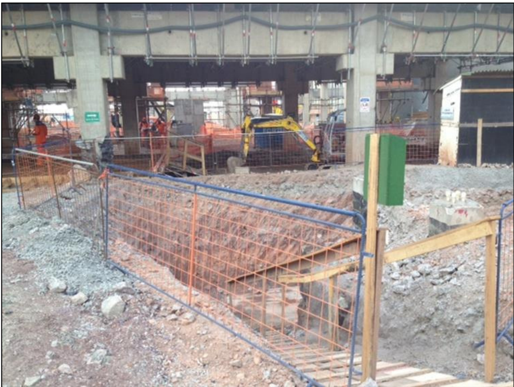
Figura 69: rampa sem guarda-corpo. Fonte: Arquivo pessoal, 2012.
