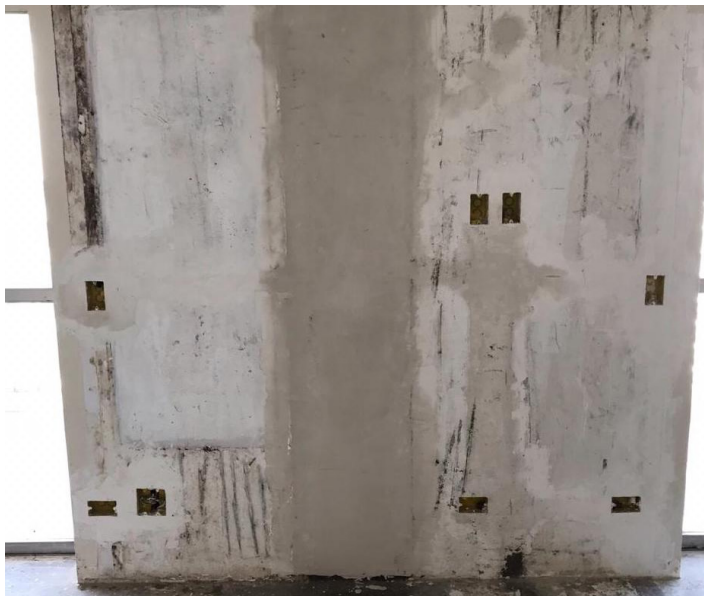
F.67 Foto antes do tratamento das paredes da suíte
