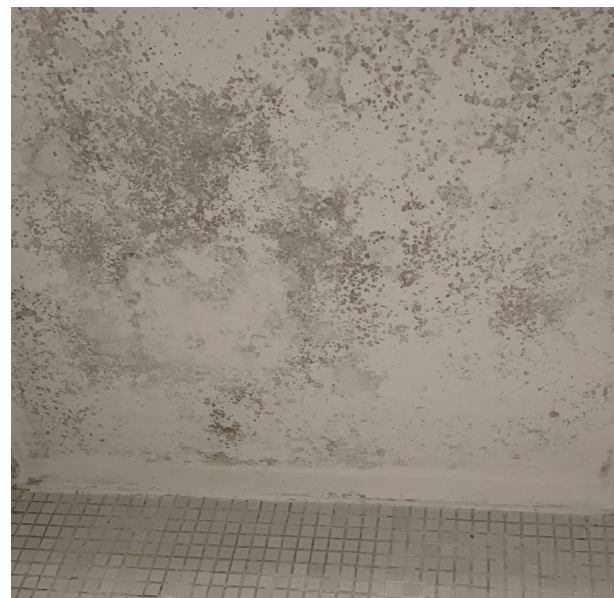
F.109 Teto do chuveiro com mofo
