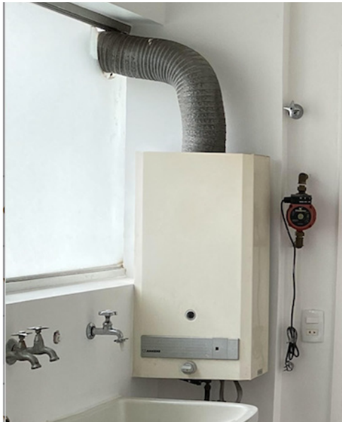
F.83 Aquecedor antes da obra
