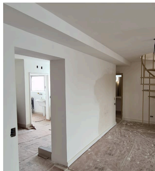
F.66 Foto depois do tratamento das paredes da sala
