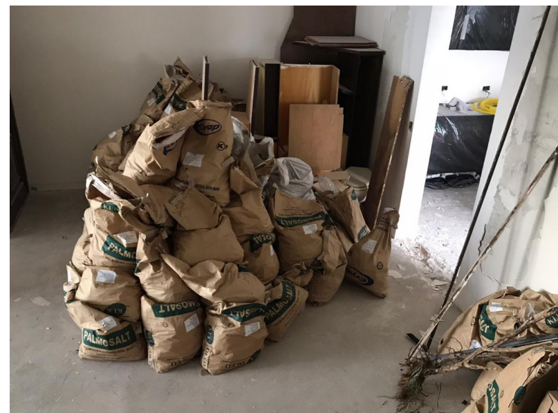
F.86 Disposição inadequada de entulho
