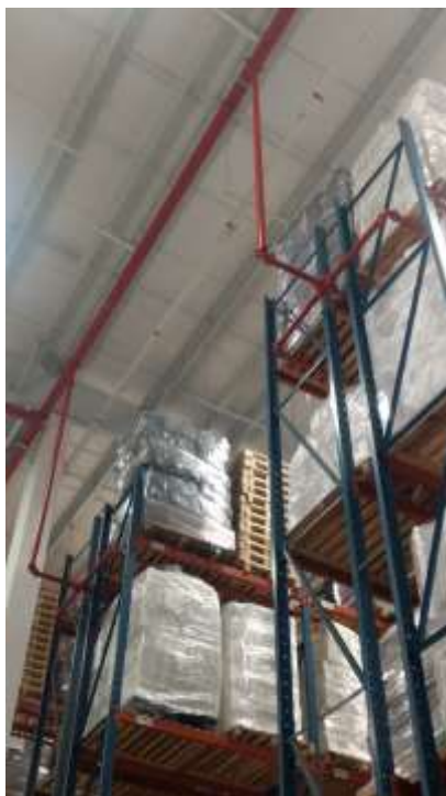
Figura 14 – Dentro dos Prédios: Racks
