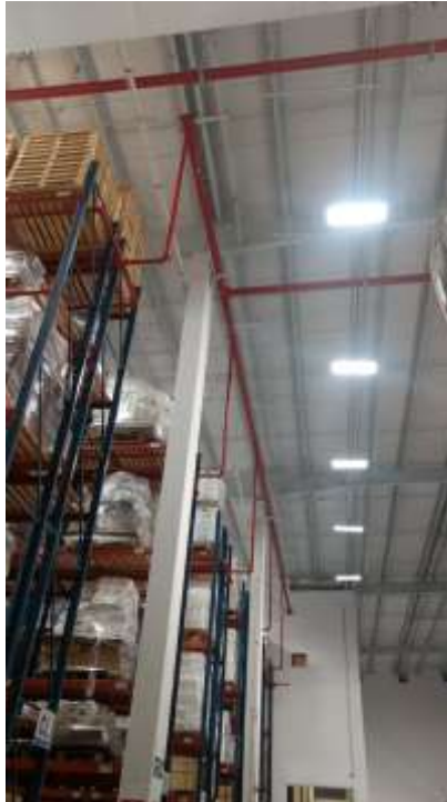
Figura 15 – Dentro dos Prédios: Racks
