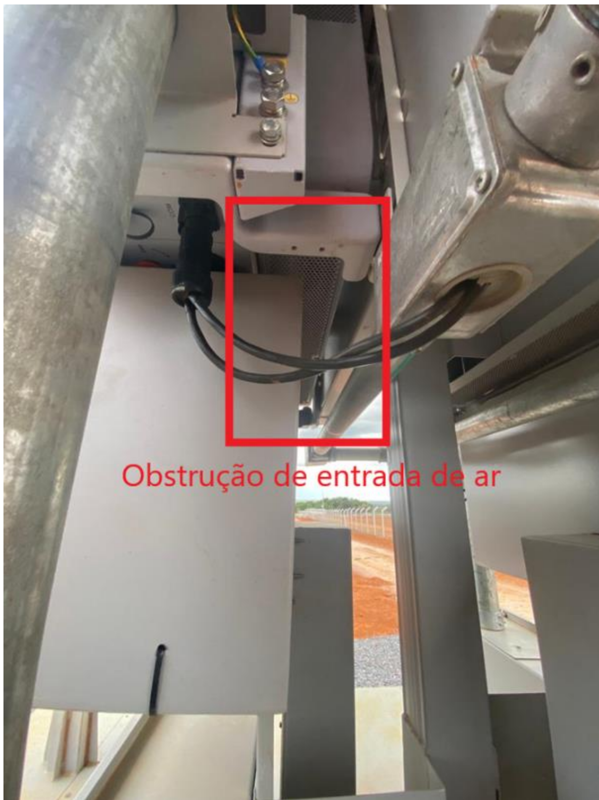
Figura 33 — Obstrução na entrada de ar do inversor
