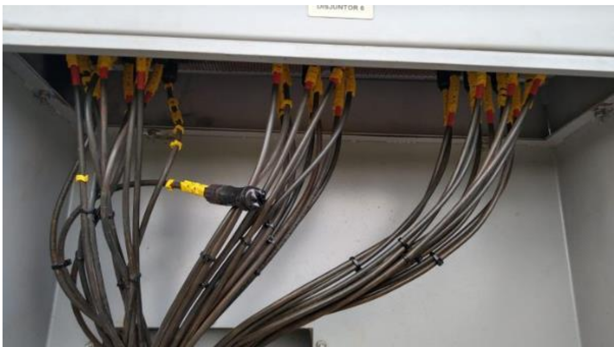
Figura 36 — Deterioração do conector do inversor
