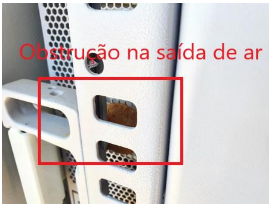
Figura 34 — Obstrução na saída de ar do inversor
