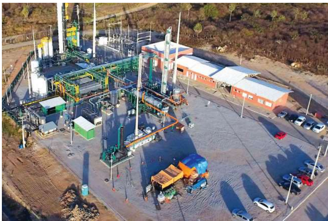
Figura 4 - Usina de Caucaia com geração de biometano através de RSU.
