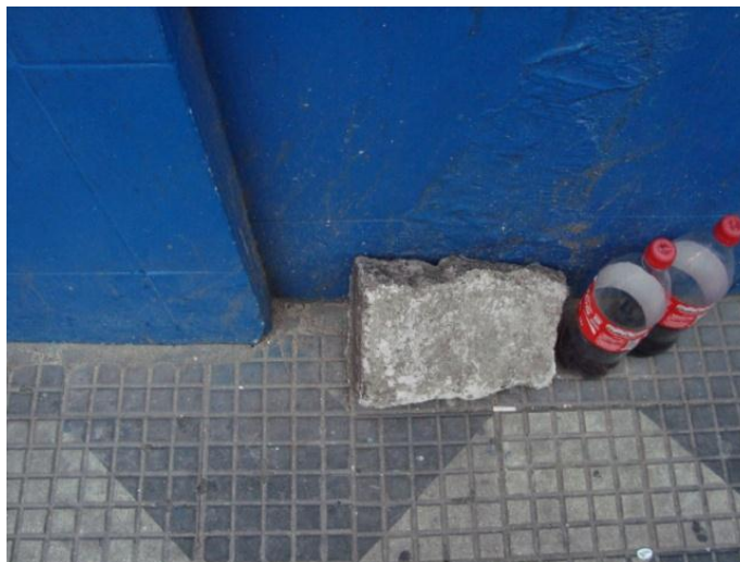
Figura 9.7 - Bloco descolado da alvenaria.
