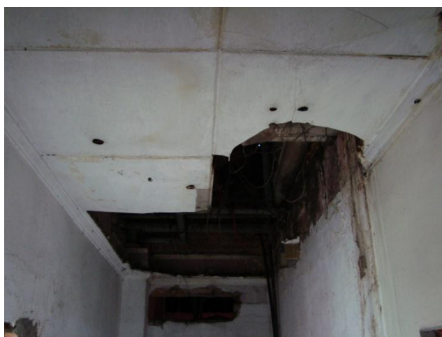
Figura 9.19 - Manchamento dos forros de gesso por infiltração.
