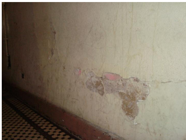
Figura 9.11 - Parede entre fachada e área interna com patologias devido à umidade.
