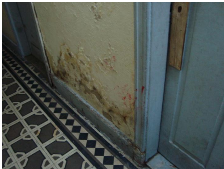
Figura 9.12 - Descolamento de película próximo ao rodapé.
