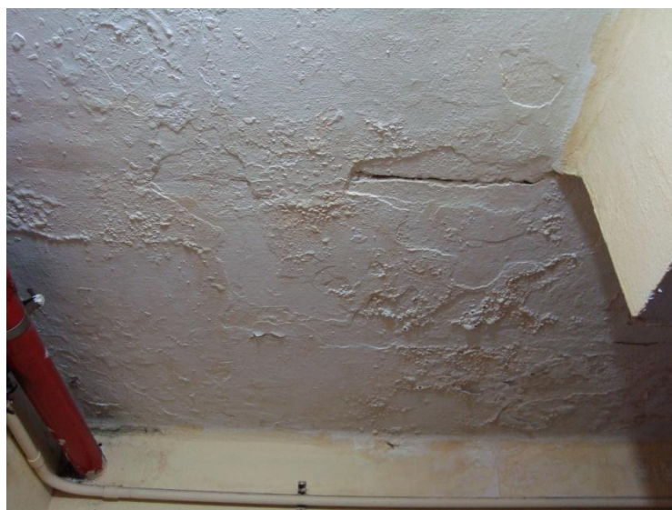
Figura 9.14 - Focos de infiltração.
