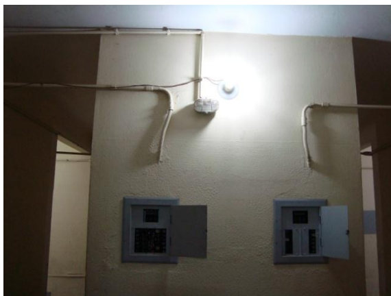
Figura 9.20 - Instalação elétrica recentemente reformada.
