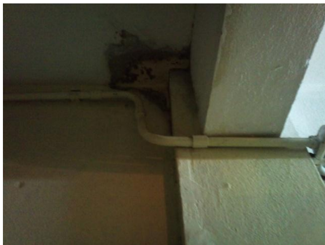
Figura 9.15 - Infiltração advinda de tubulação ou reservatório.
