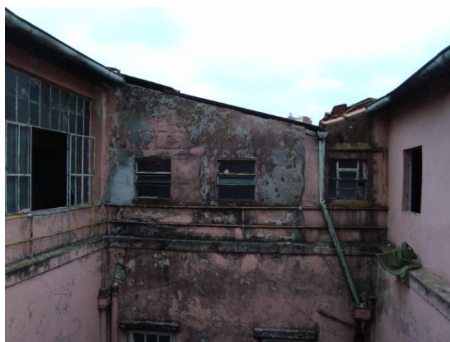
Figura 9.10 - Paredes expostas à umidade com desenvolvimento de bactérias.
