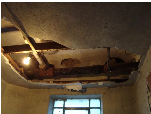
Figura 9.16 – Forros destruídos nos banheiros expondo a tubulação.
