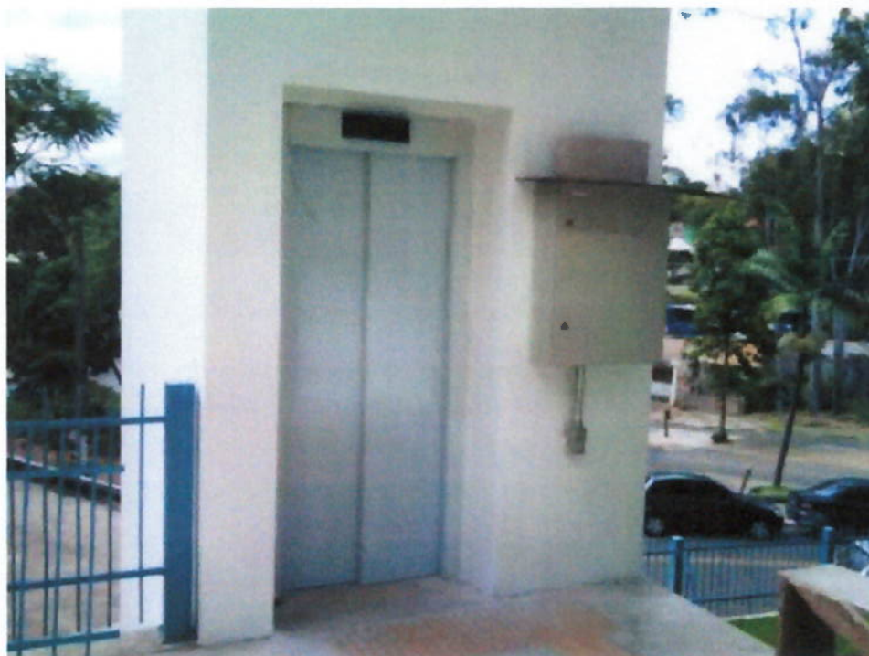
figura 08 - Mostra o quadro do elevador instalado
