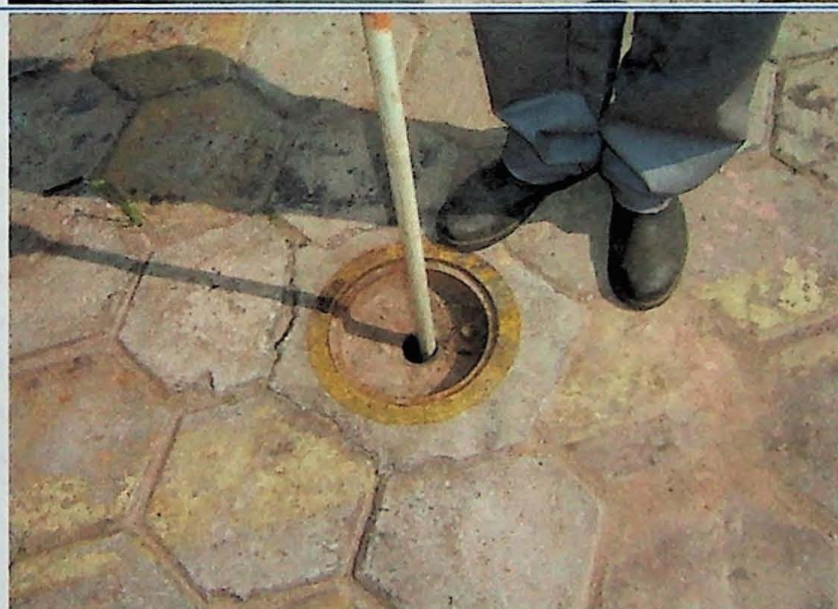
Foto 06 - Detalhe da tubulação interna ao Poço de Extração.
