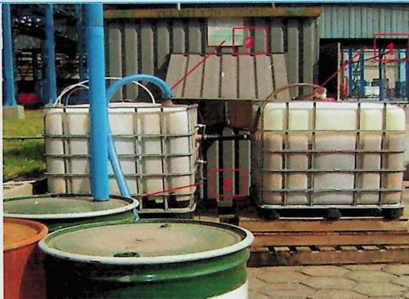
Foto 01 - Vista geral do container do MPE - tanques de armazenagem.
