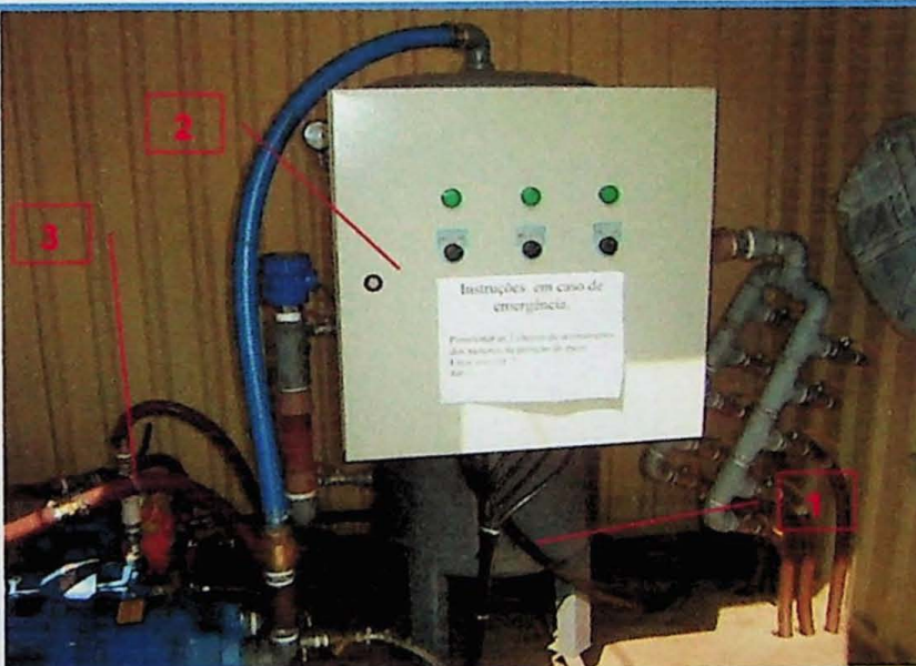
Foto 02 - Vista geral do interior do sistema de controle e bombas.
