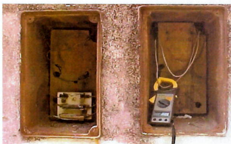
Figura 14 – Ligação direta dentro da caixa de medição
