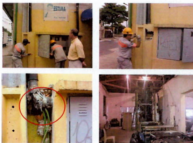
Figura 16 – Derivação escondida na alvenaria do imóvel
