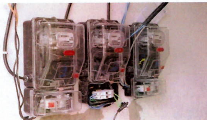
Figura 18 – Caixas de Medição (AES Eletropaulo)
