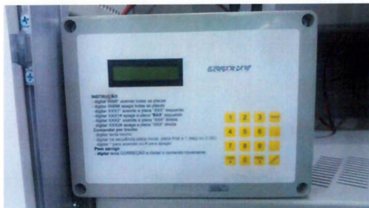
Figura 12 – Módulo Gerador DTMF existente.
