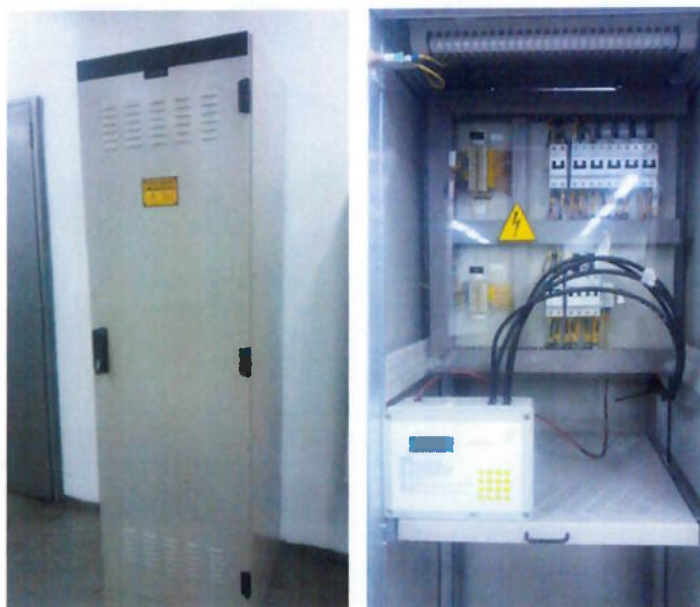
Figura 11 – Vista externa e interna do Painel de Controle de Rotas de Fuga (PCRF) em implantação
