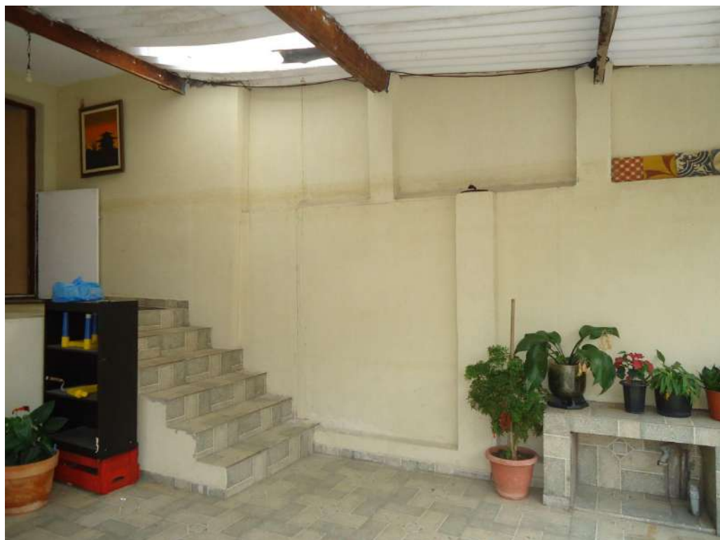
Figura 40: Marca d'água em garagem de morador (Trecho 1). Fonte: Autora, 2019
