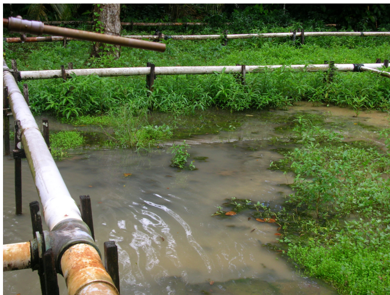
Figura 38. Rede de canos do sistema de captação da COSANPA. Alagamento na superfície de praticamente todos os poços.
