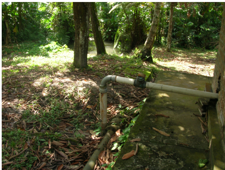
Figura 41. Canalização saindo de poço de micro sistema de Tauarizinho; inexistência laje de cobertura. FONTE: Arquivo próprio.
