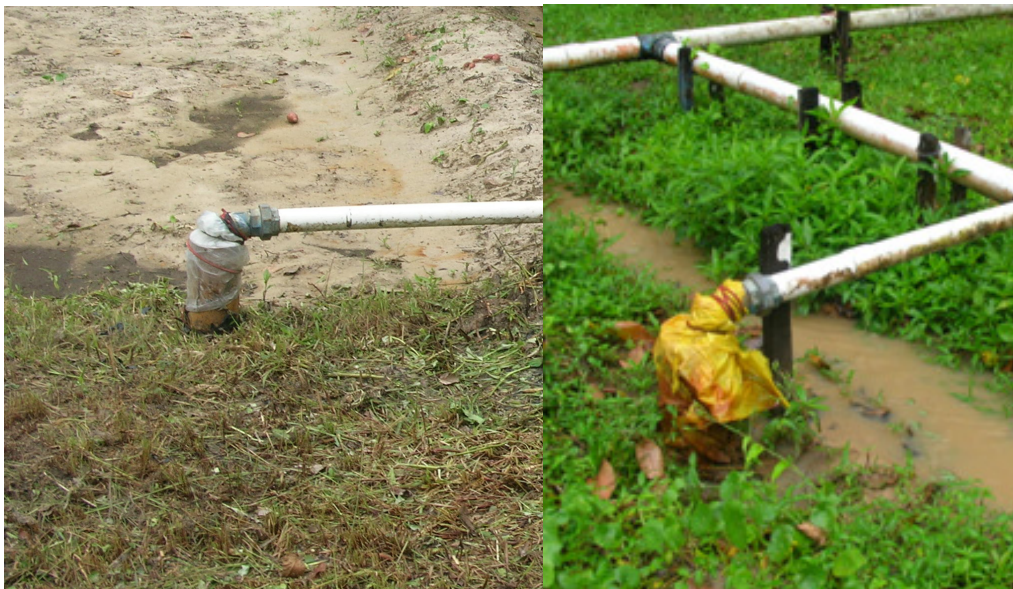
Figura 37. Poços do sistema de abastecimento da COSANPA, não sendo observadas proteções ou laje de cobertura.
