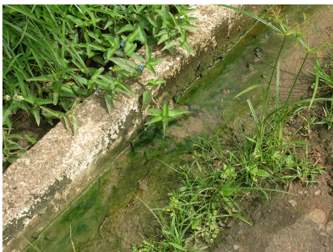
Figura 42. Canaleta localizada na sede municipal, com proliferação de algas em decorrência do constante lançamento de efluentes domésticos.
