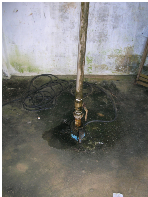
Figura 40. Canalização saindo de poço do micro sistema de Piçarreiras; existência de laje de cobertura. FONTE: Arquivo próprio.
