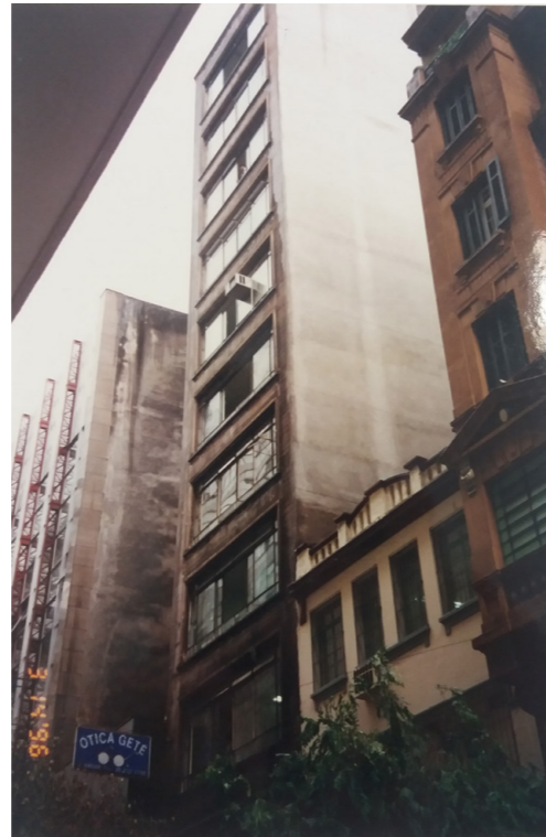
Segunda foto anexada mostrando que o edifício não possuía recuo lateral com o imóvel nº 211. Foto de autoria própria do documento arquivado na Prefeitura de São Paulo.
