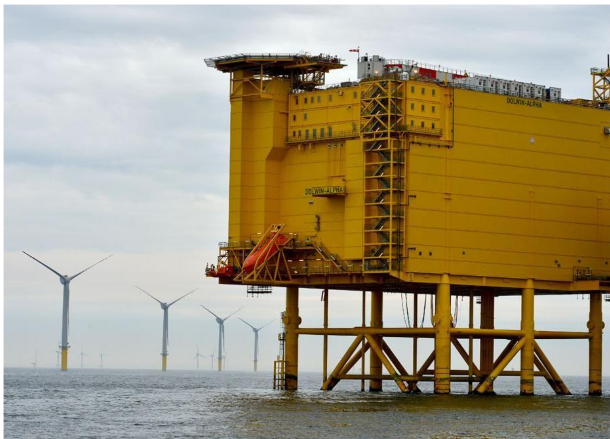
Figura 6.3 — Subestação offshore DolWin Alpha
