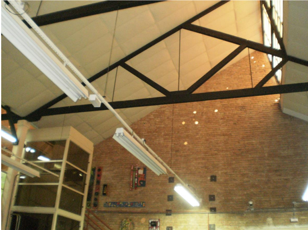
Figura 11 - Luminárias que utilizam lâmpadas tipo HO de 110W.
