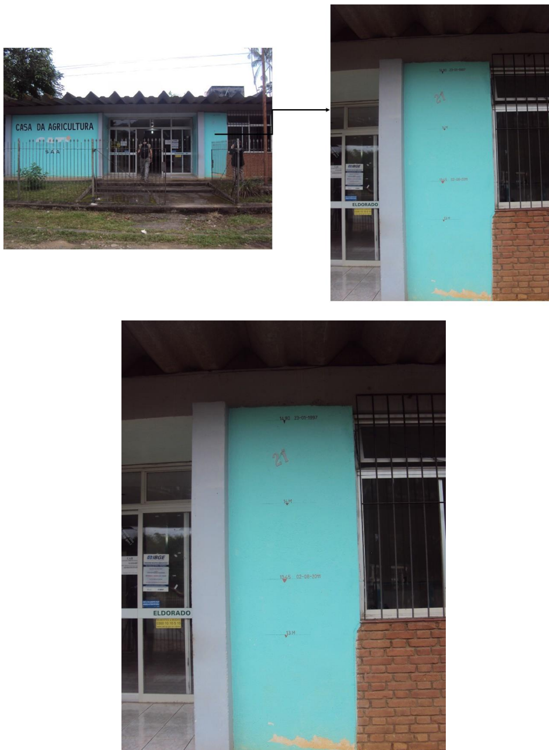
Figura 19 - Registros de eventos de inundação na Casa de Agricultura de Eldorado.
