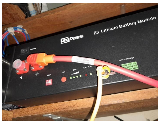
Figura 3.16 - Instalação da bateria Dyness B3
