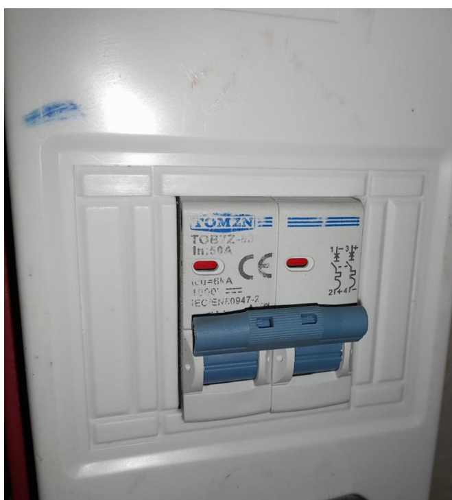
Figura 3.20 - Disjuntor DC para proteção da bateria.
