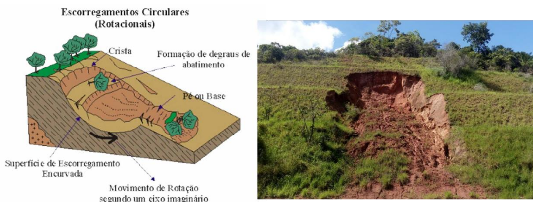
Figura 3. Perfil esquemático de escorregamento rotacional e Cicatriz de Escorregamento rotacional em um trecho da BR-101, PE; Fonte: TOMINAGA (2012) e Fonte: Carlos Bispo
